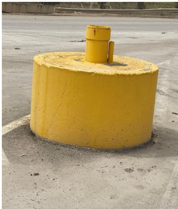
Εικόνα 19. φρεάτιο ελέγχου στραγγισμάτων (κατάντι)
