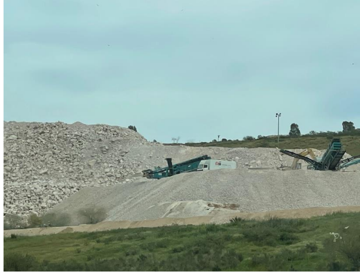
Εικόνα 3. Σπαστήρας προϊόντων εκσκαφής και αποθεσιοθάλαμοι υλικού
