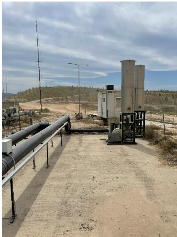
Εικόνα 18. Κεντρικός αγωγός μεταφοράς βιοαέριου - πυρσοί καύσης
