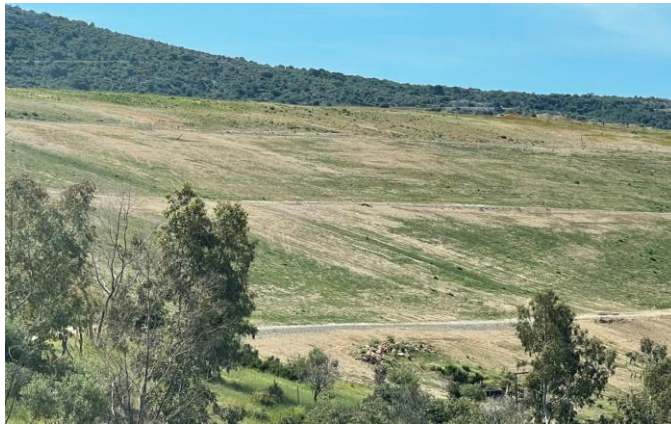
Εικόνες 25,26. Αστοχία αποκατάστασης και εκ νέου αποκατάσταση πρανών-αποκατεστημένη φάση
