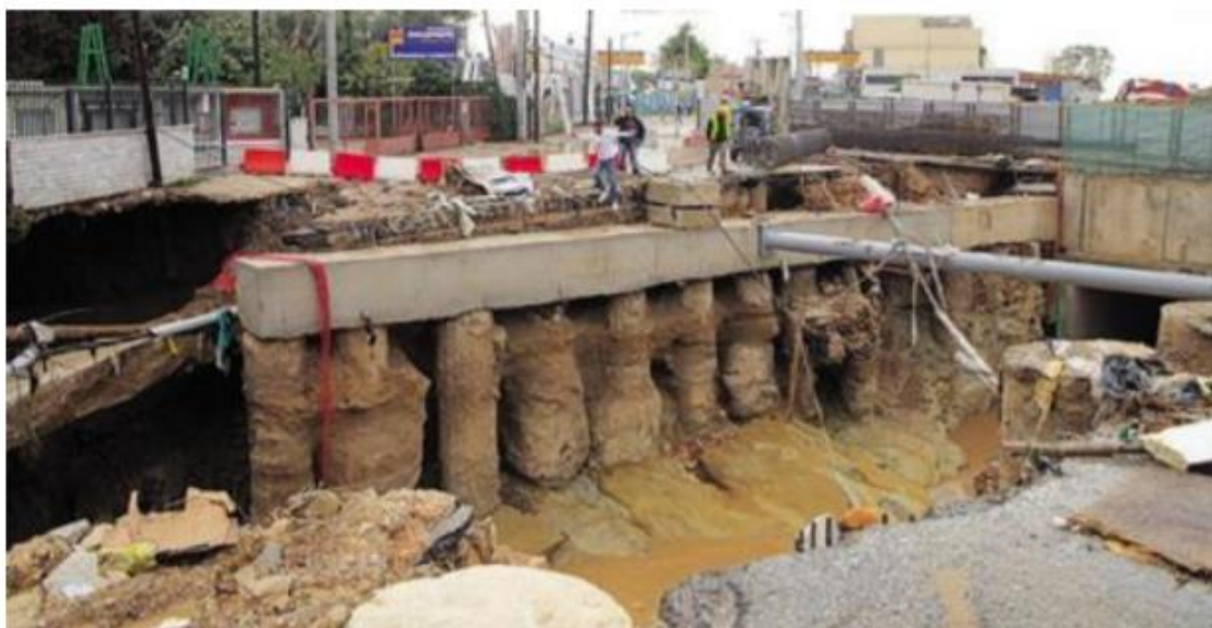
Σχήμα 6: Σημείο υποχώρησης του οδοστρώματος στο σημείο όπου γίνονται εργασίες στο ρέμα της Εσχατιάς στο Καματερό. Πηγή: (Espresso, 2017)
