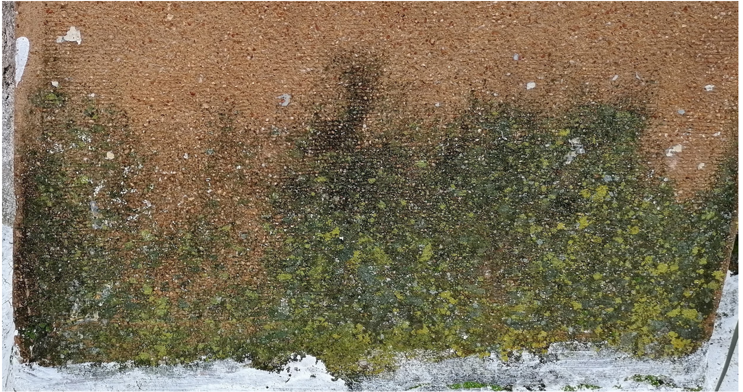
Εικόνα 3.3.38: Βιολογική διάβρωση του επιχρίσματος στο κάτω μέρος της βορειοανατολικής πλευράς του ναού δίπλα από την θύρα
