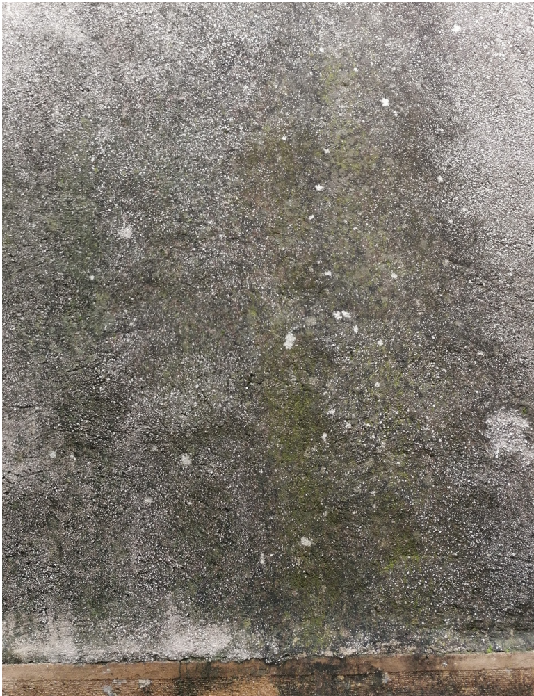
Εικόνα 3.3.40:Βιολογική διάβρωση του επιχρίσματος στο πάνω μισό μέρος της Ανατολικής πλευράς του ναού
