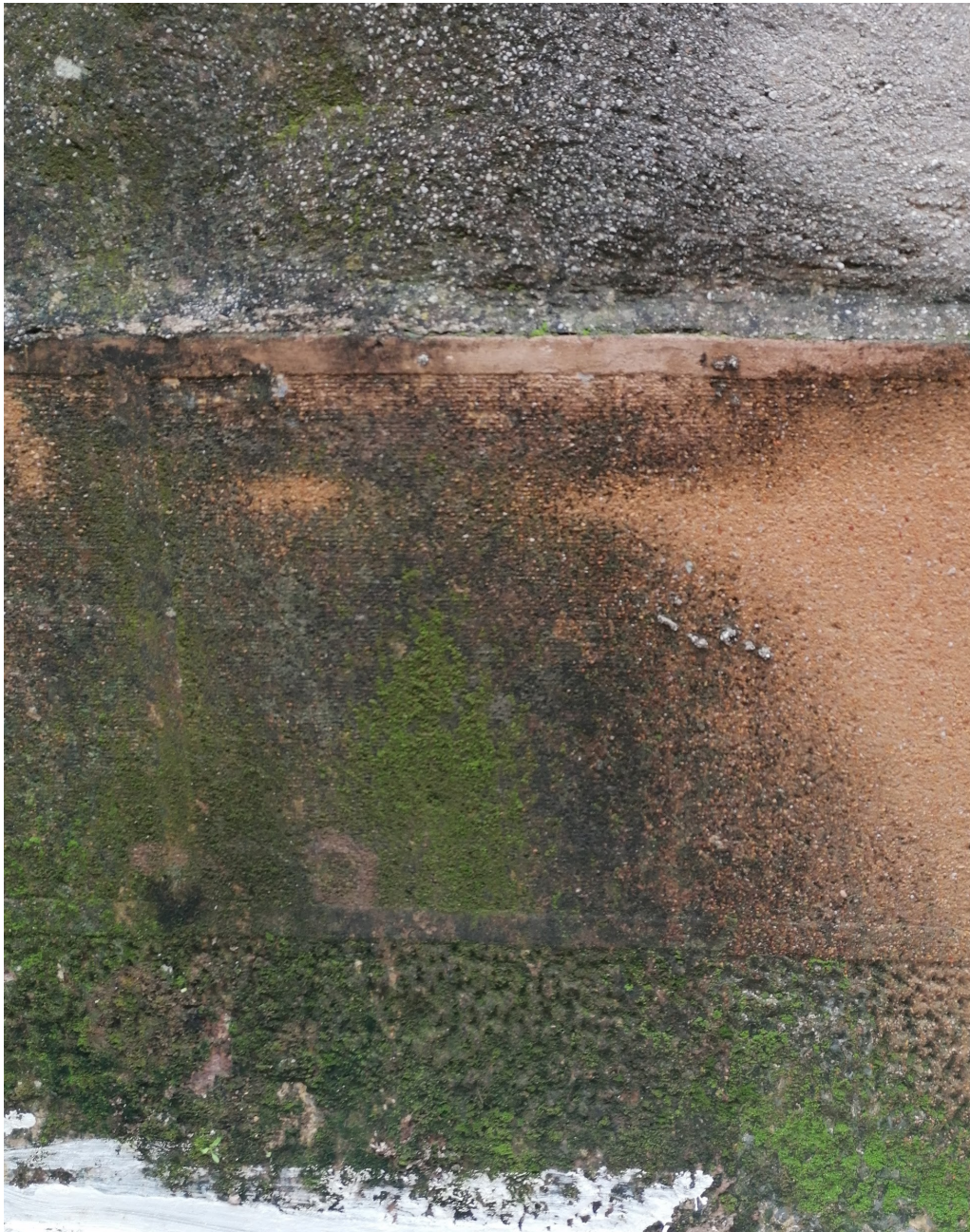
Εικόνα 3.3.39: Βιολογική διάβρωση του επιχρίσματος στο κάτω μέρος της Ανατολικής πλευράς του ναού
