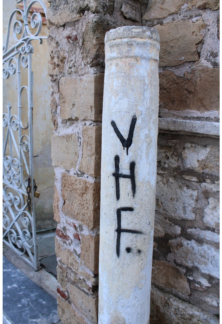
Εικόνα 3.4.43: Φωτογραφική αποτύπωση βανδαλισμού σε κολώνα του ναού που βρίσκεται δεξιά της μεταλλικής πόρτας που οδηγεί στον προαύλιο χώρο
