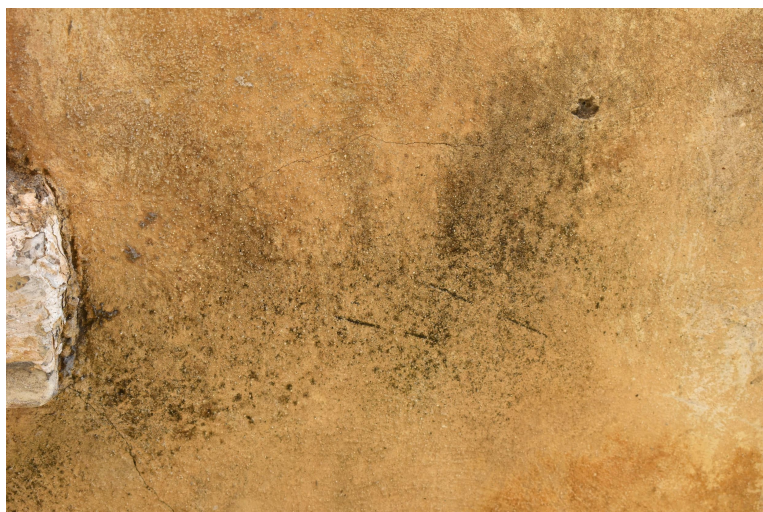
Εικόνα 3.1.2.36: Ανάπτυξη μικροοργανισμών στην Νότια πλευρά του ναού λόγω υγρασίας
