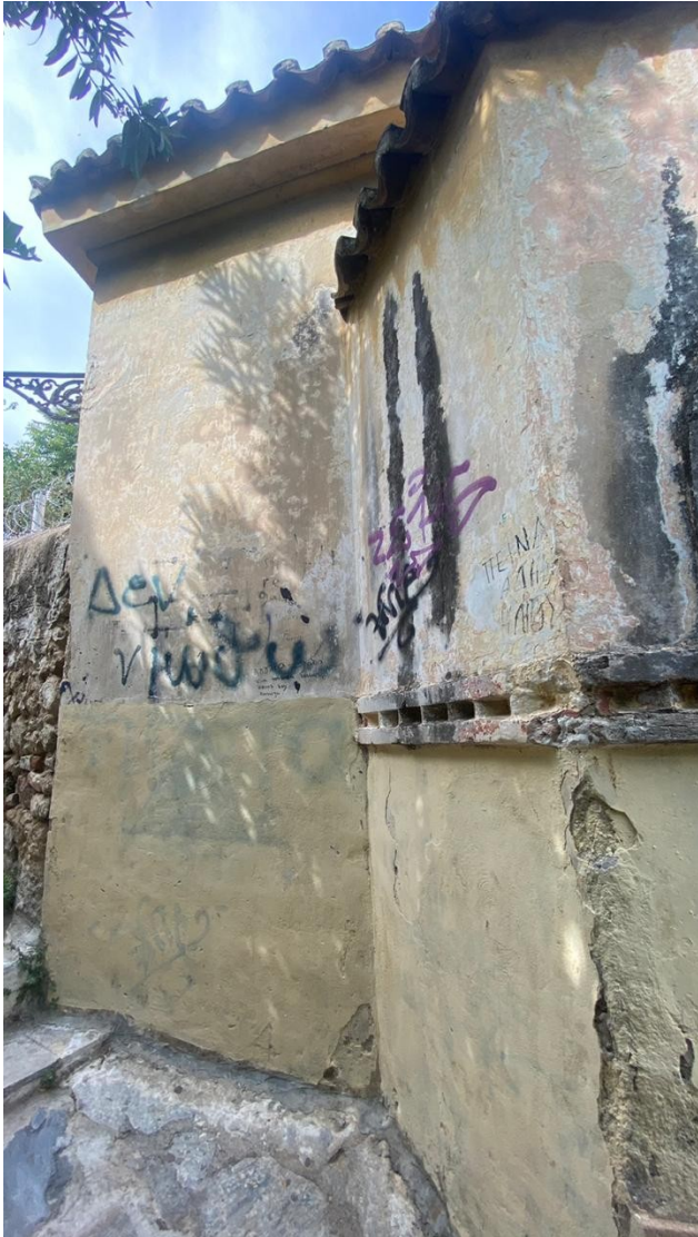
Εικόνα 3.4.42: Φωτογραφική αποτύπωση των βανδαλισμών που έχει υποστεί ο ναός στην νοτιοανατολική πλευρά του
