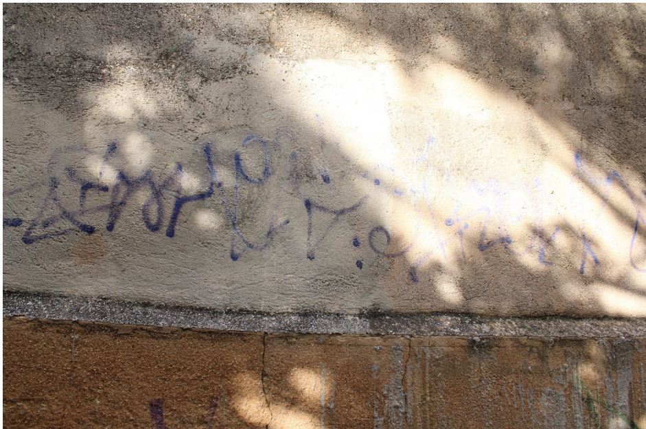
Εικόνα 3.4.44: Φωτογραφική απεικόνιση βανδαλισμού στην βορειοανατολική πλευρά του ναού.
