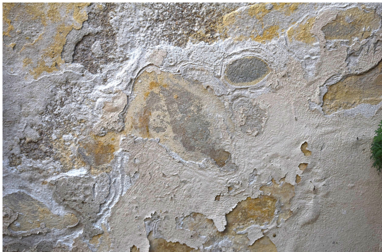
Εικόνα 3.1.2.35: Απολέπιση χρώματος στην τοιχοποιία στην Νότια πλευρά του ναού λόγω αυξημένης υγρασίας
