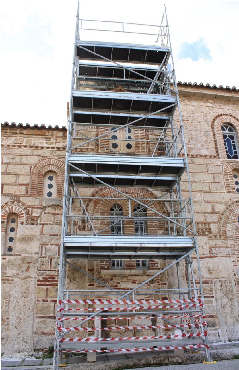
Εικόνα 4.3.46: Έργα αποκατάστασης του Αθηναϊκού τρούλου στον Ι.Ν. Αγίου Νικολάου Ραγκαβά κατά τη χειμερινή περίοδο του έτους 2019
