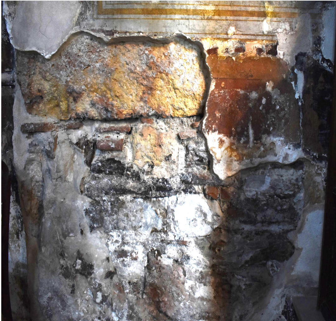
Εικόνα 3.1.2.30: Απώλεια κονιάματος σε σημείο τοιχοποιίας λόγω τριχοειδούς αναρρίχησης της υγρασίας. Βρίσκεται νότια του τέμπλου στο εσωτερικό του ναού.
