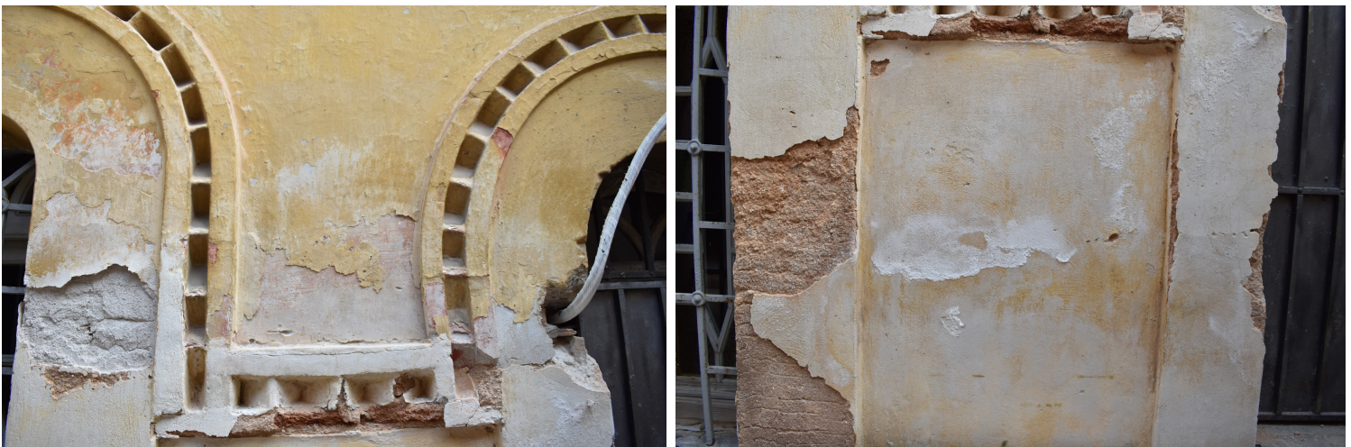
Εικόνα 3.1.2.34: Απολέπιση χρώματος και δομικού υλικού στην περιοχή των παραθύρων στην Νότια πλευρά του ναού λόγω αυξημένης υγρασία
