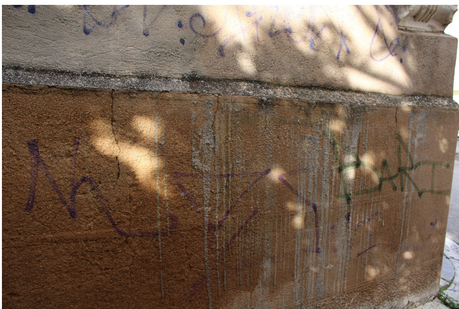
Εικόνα 3.4.45: Φωτογραφική απεικόνιση βανδαλισμού στην βορειοανατολική πλευρά του ναού.
