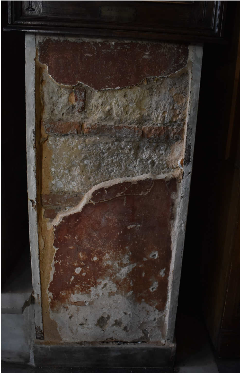
Εικόνα 3.1.2.31: Απώλεια κονιάματος σε κολώνα στο εσωτερικό του Ι.Ν. Αγίου Νικολάου Ραγκαβά λόγω ανάπτυξης της υγρασίας
