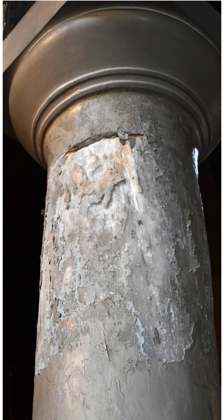
Εικόνα 3.1.2.29: Απώλεια δομικού υλικού στο στο κιονόκρανο της Νοτιοανατολικής κολώνας στο εσωτερικό του ναού
