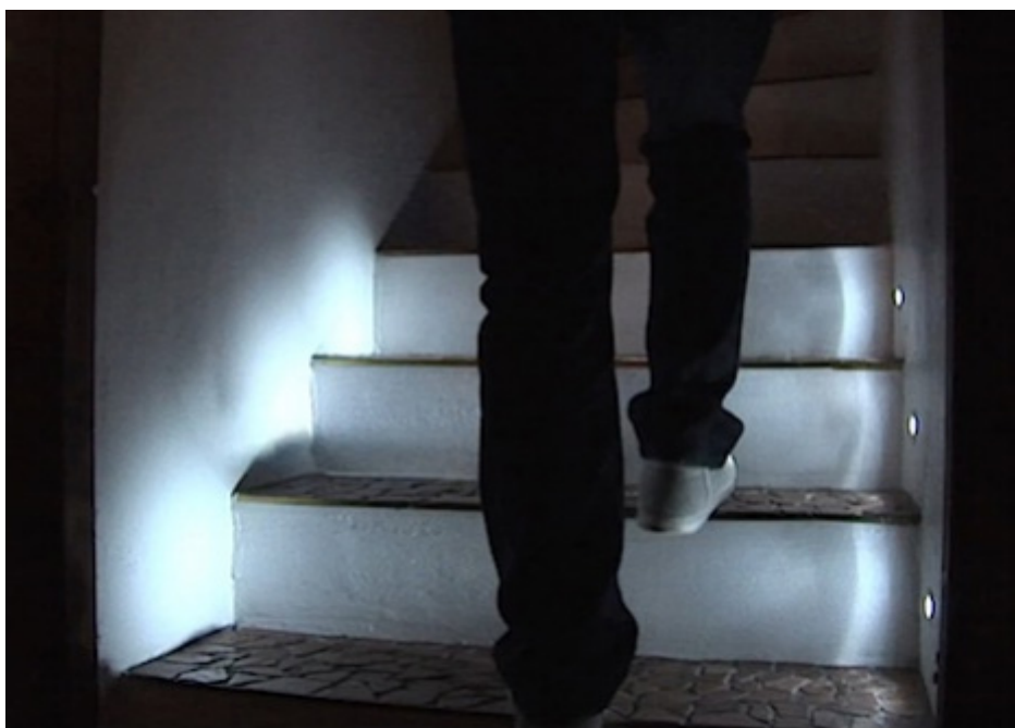
Εικ. 94: Φωτιστικό σώμα με αισθητήρες κίνησης.
