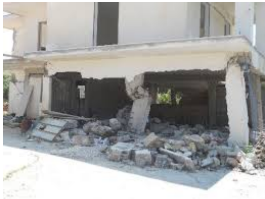
Εικόνα 2.5 Εκτός επιπέδου αστοχία τοιχοπληρώσεων
