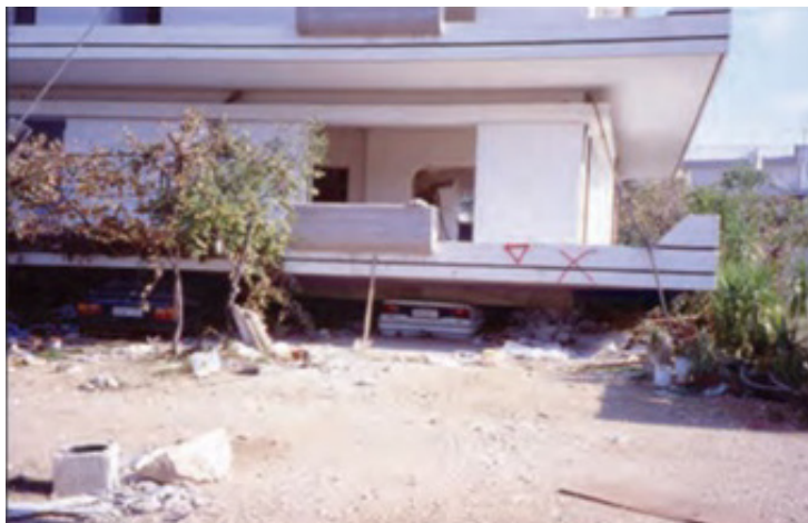
Εικόνα 2.1 Αστοχία μαλακού ορόφου σε πιλοτή, σεισμός Αιγίου, 1995.
