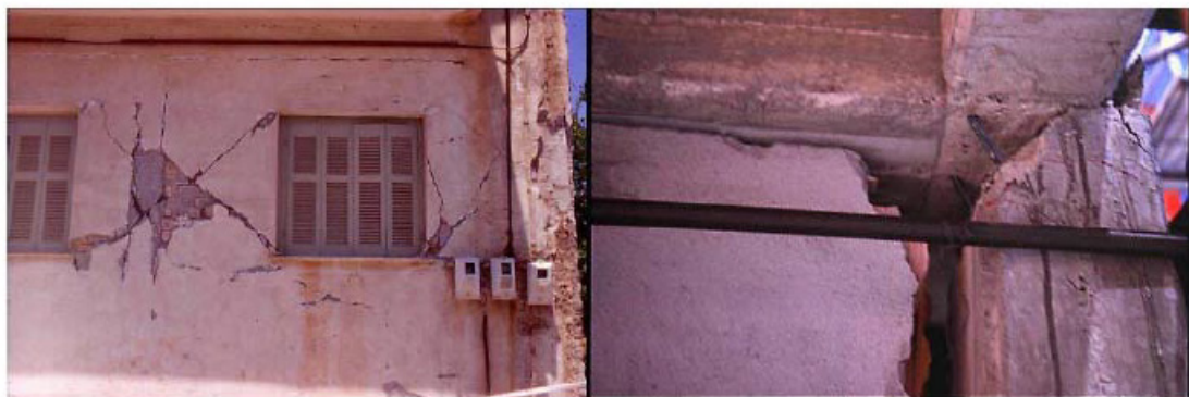
Εικόνα 2.4 Αστοχία υποστυλωμάτων λόγω ισχυρών τοιχοπληρώσεων
