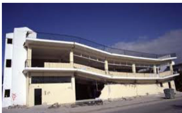
Εικόνα 2.3 Αστοχίες κοντών υποστυλωμάτων, σεισμός Αθήνας 1999
