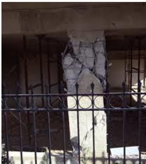
Σχήμα 3.3: Διατμητική αστοχία λόγω ανεπάρκειας συνδετήρων στο υποστύλωμα.
