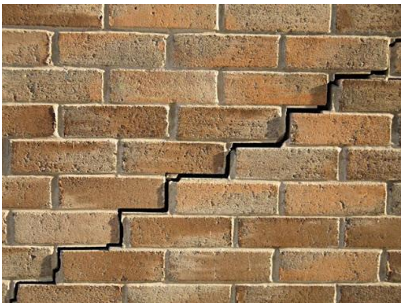
Σχήμα 2.2: Εφελκυστική αστοχία λόγω μικρής συνάφειας κονιάματος με λιθόσωμα
