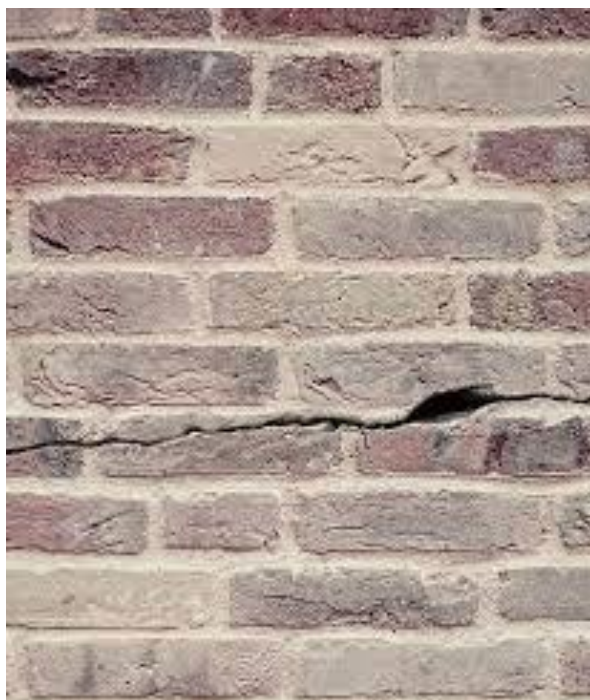
Σχήμα 2.1: Εφελκυστική αστοχία λόγω ασθενούς λιθοσώματος
