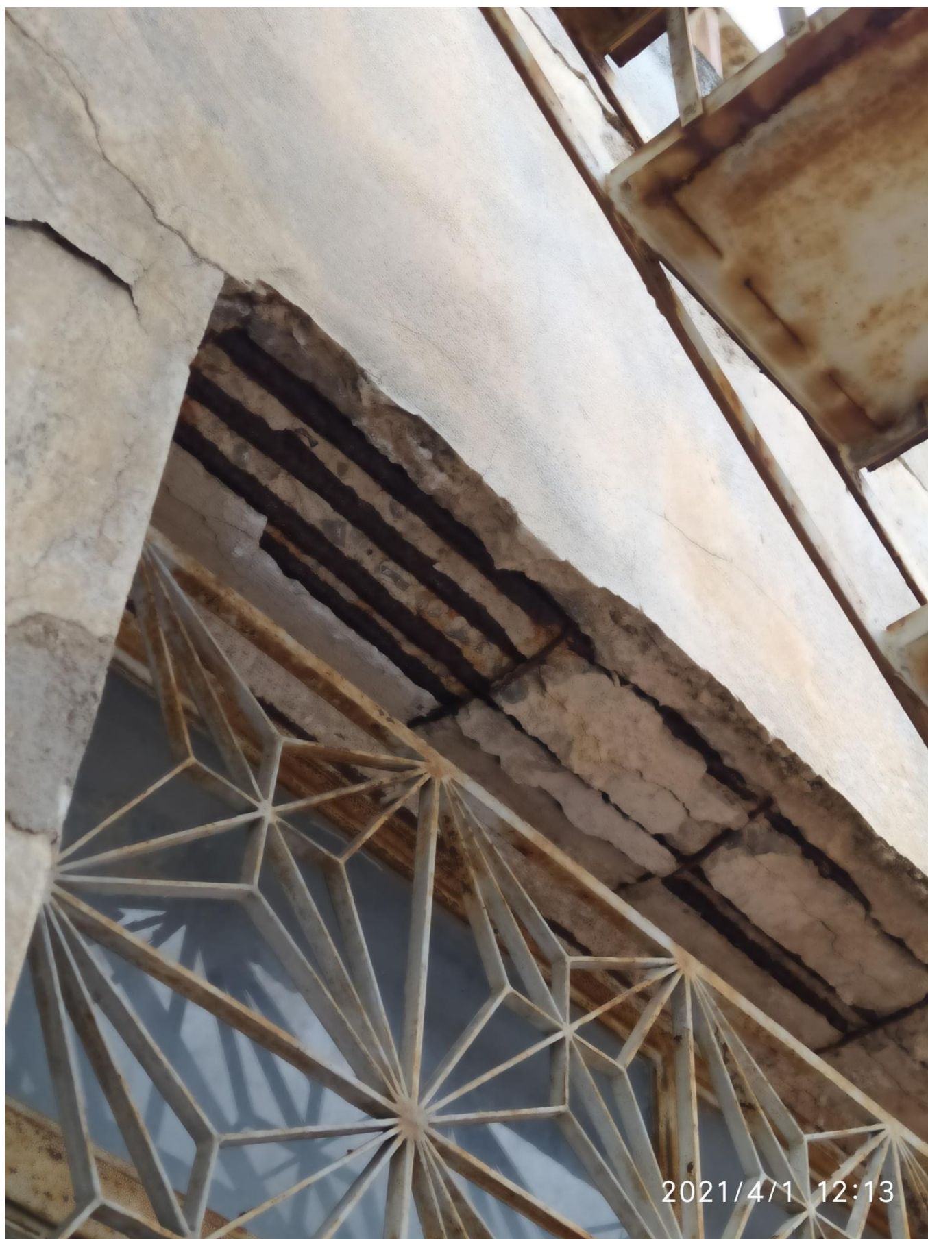
Εικ.2.2 Αποφλοίωση κάτω πέλματος δοκού Δ1.1(2)
