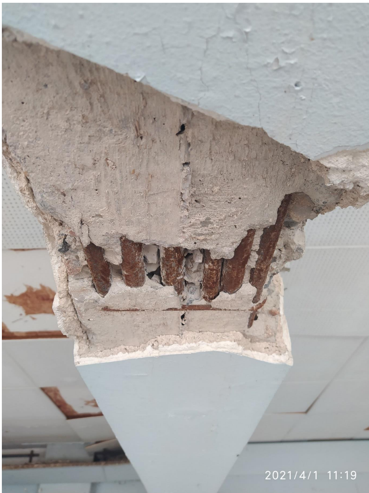
Εικ.2.6 Αποκάλυψη του κύριου οπλισμού (3Φ16+3Φ20) στη δοκό Δ.8.1(3)
