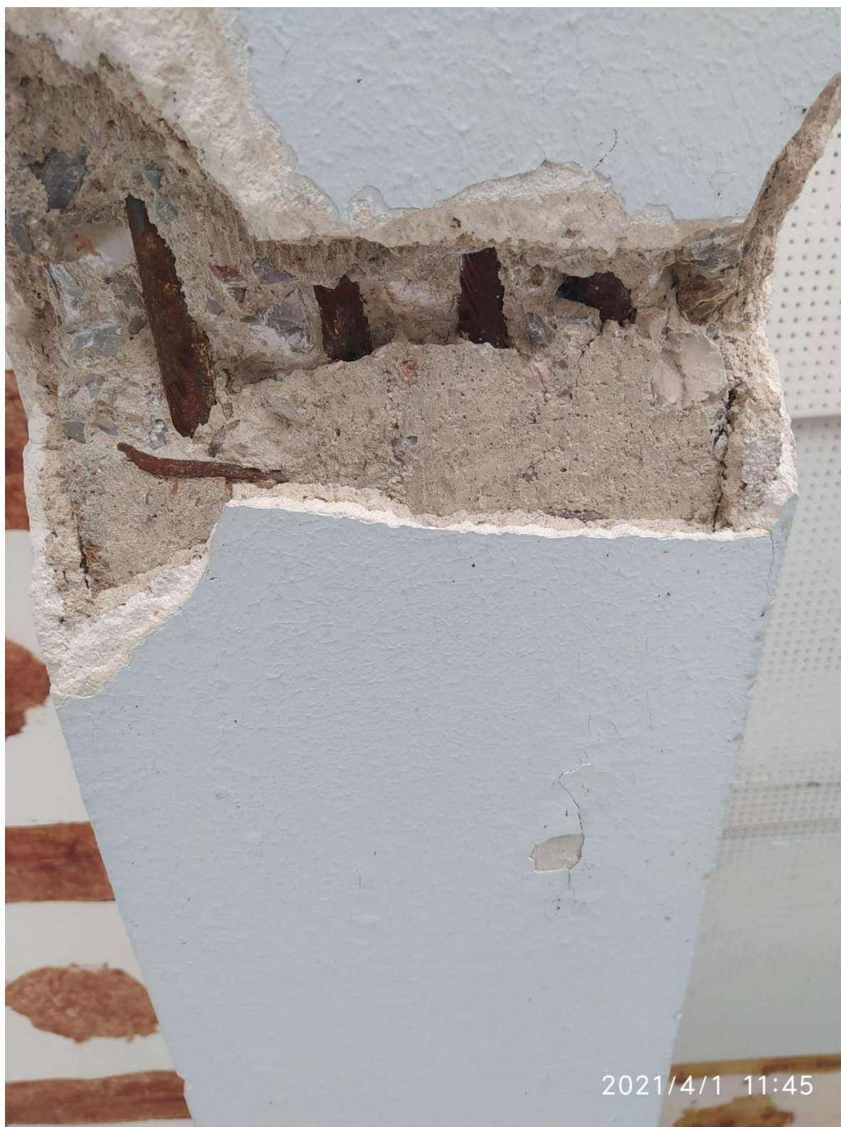
Εικ.2.7 Αποκάλυψη του κύριου οπλισμού (4Φ20) στη δοκό Δ.9.1(3)
