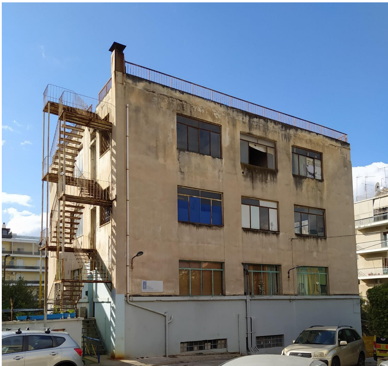
Εικ.2.5 Διαφορετική οπτική γωνία του υφιστάμενου κτιρίου. Φαίνεται ο πλευρικός οπλισμός 5Φ6/πλευρά στην αποφλοιωμένη δοκό της τελευταίας στάθμης
