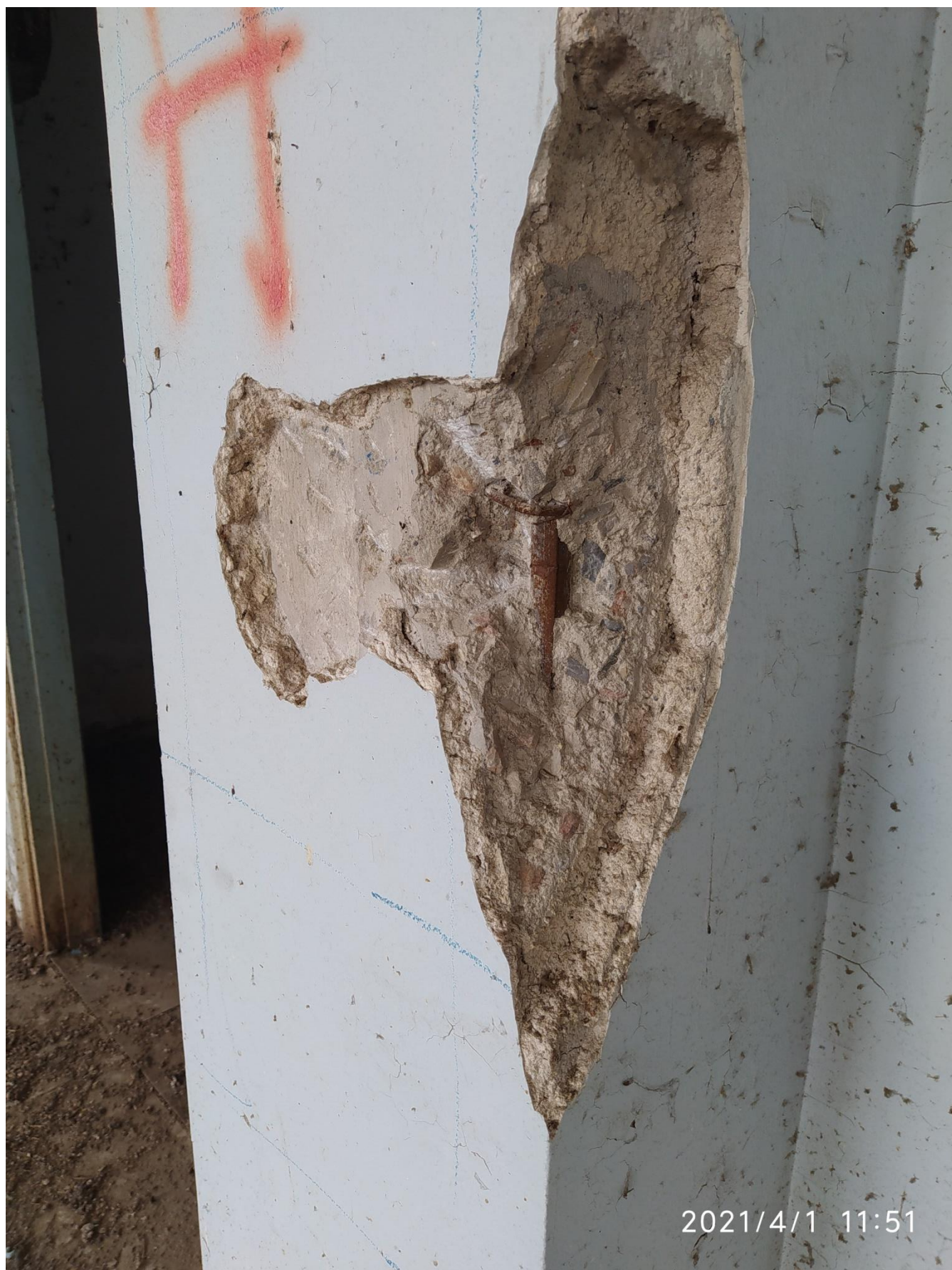
Εικ.2.8 Αποκάλυψη διαμήκους κύριου οπλισμού στην κολώνα Κ7(3)
