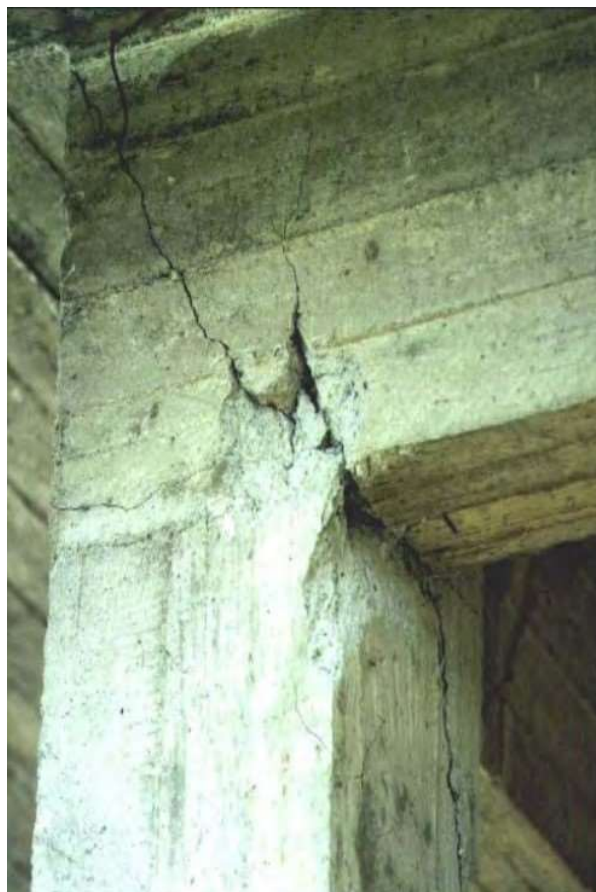
Εικόνα 6.1: Διατμητική Αστοχία Γωνιακού Κόμβου της Κατασκευής
