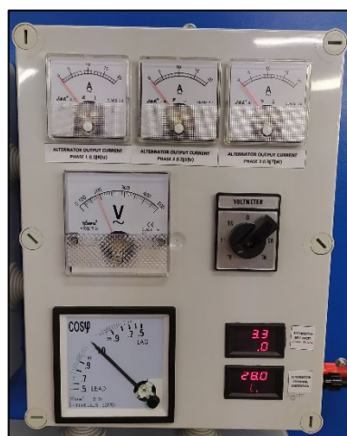
Εικόνα 4.2-21: Πίνακας επιτήρησης της γεννήτριας Αρχειακό υλικό
