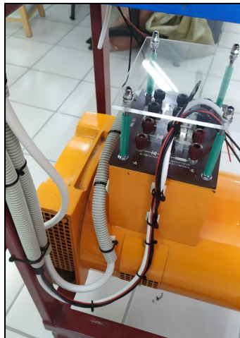
Εικόνα 4.1-3: Κατασκευαστική λεπτομέρεια στην καλωδίωση της γεννήτριας Αρχαιακό υλικό
