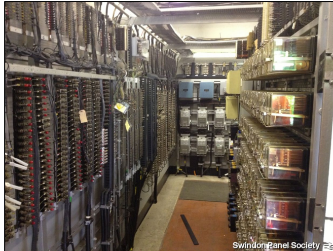
Εικόνα 1.2-5: Εγκατάσταση ελέγχου με ηλεκτρονόμους σε σιδηροδρομική εφαρμογή
