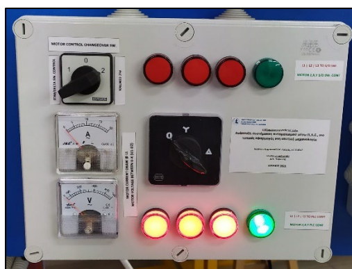
Εικόνα 4.2-17: Πίνακας ελέγχου του κινητήρα Αρχειακό υλικό
