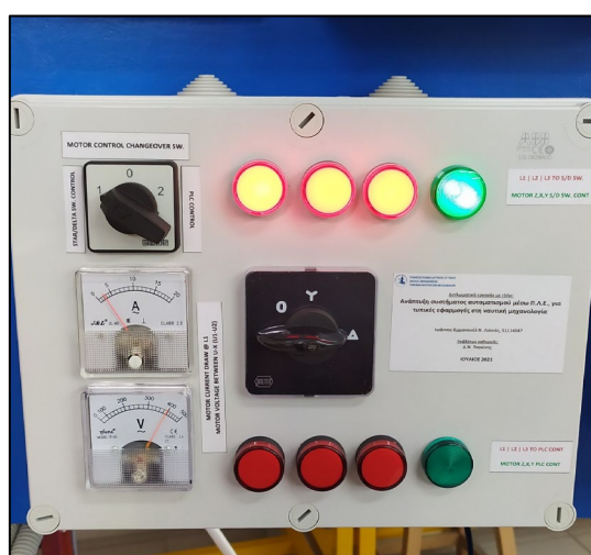
Εικόνα 4.1-5: Χειρισμός του κινητήρα με το διακόπτη μεταγωγής αστέρα-τριγώνου
