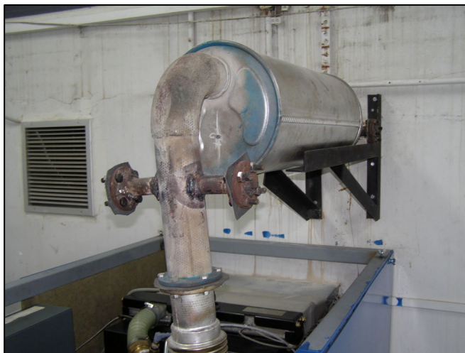
Εικόνα 3.2-7: Παρεμβύσματα (φλάντζες) εγκατάστασης των οπτικών κεφαλών στον αγωγό καυσαερίων Αρχειακό υλικό
