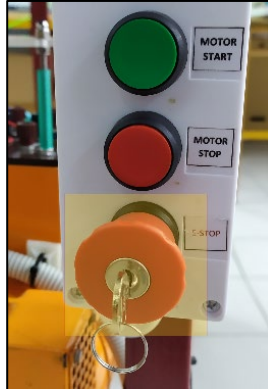
Εικόνα 4.2-12: Ο διακόπτης εκτάκτου ανάγκης Αρχειακό υλικό
