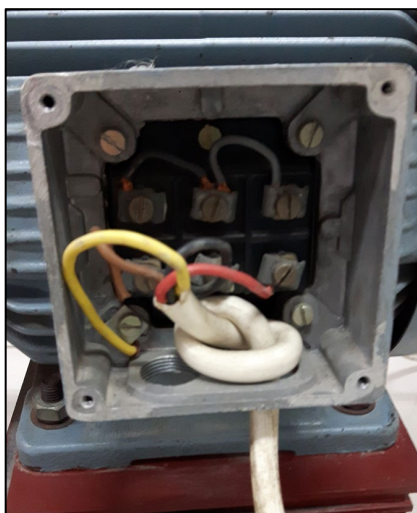
Εικόνα 3.3-3: Αρχική κατάσταση καλωδίωσης κινητήρα Αρχειακό υλικό
