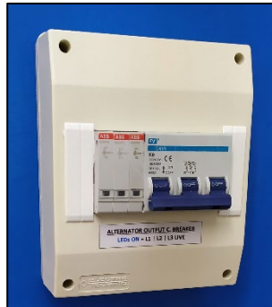
Εικόνα 4.2-15: Διακόπτης ενεργοποίησης της εξόδου της γεννήτριας Αρχειακό υλικό
