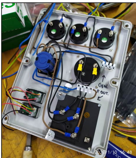
Εικόνα 3.3-24: Ενδεικτική απεικόνιση της καλωδίωσης των σταθερών συσκευών σε κντίο εξοπλισμού Αρχειακό υλικό
