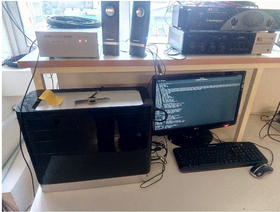
Σχήμα 26: Εγκατάσταση σταθμού VLF UWA στο Πανεπιστήμιο Δυτικής Αττικής (αίθουσα ZB103): ο δέκτης συνδεδεμένος με τον υπολογιστή (με λειτουργικό Linux) στον οποίο γίνεται η εγκατάσταση δοκιμαστικής έκδοσης του λογισμικού UltraMSK που τον ελέγχει και αποκτά τις μετρήσεις
