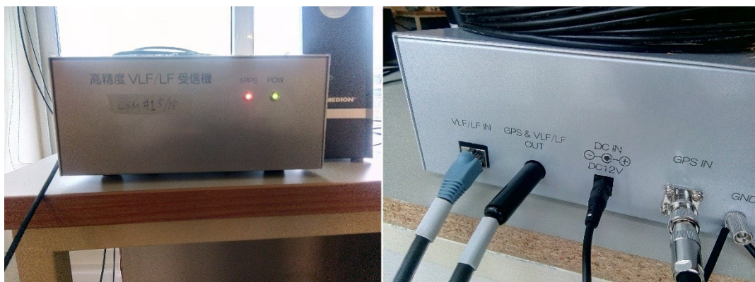
Σχήμα 25: Εγκατάσταση σταθμού VLF UWA στο Πανεπιστήμιο Δυτικής Αττικής (αίθουσα ZB103): ο δέκτης μαζί με τις εισόδους (VLF, GPS) και την έξοδο προς την κάρτα ήχου.
