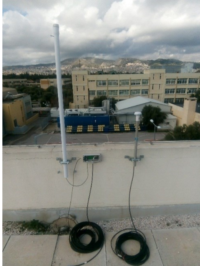
Σχήμα 24: Εγκατάσταση σταθμού VLF UWA στο Πανεπιστήμιο Δυτικής Αττικής (ταράτσα κτιρίου Z): κεραία VLF μαζί με τον προενισχυτή της και την κεραία GPS.
