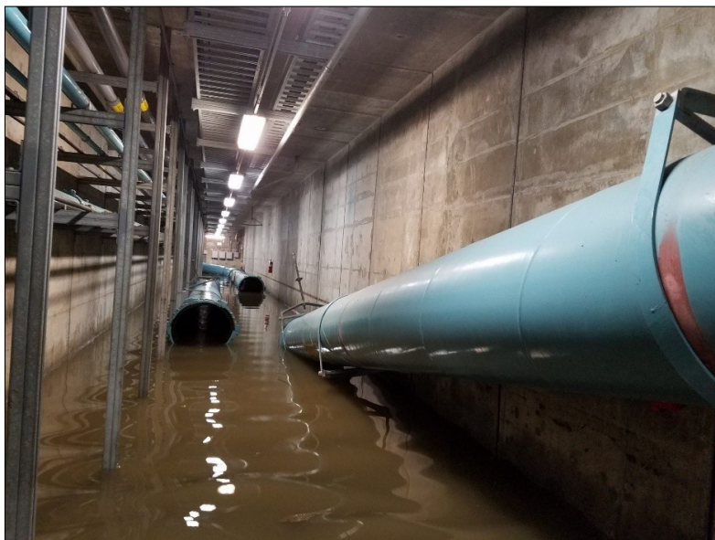
ΕΙΚΟΝΑ 3.1: Αστοχία σωλήνα Δευτεροβάθμιας επεξεργασίας, Bellingham, Washington, 2017 (Johnston, 2017).
