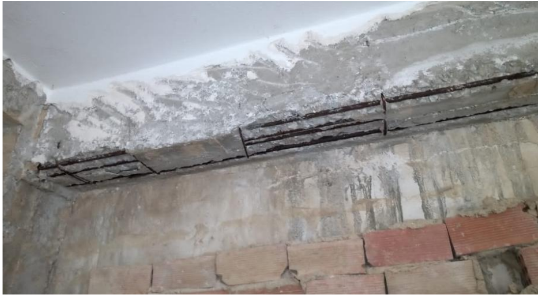
Σχήμα 6. 3 : Δοκός έπειτα από αφαίρεση επιχρισμάτων (Πηγή: Αρχείο συγγραφέα)
