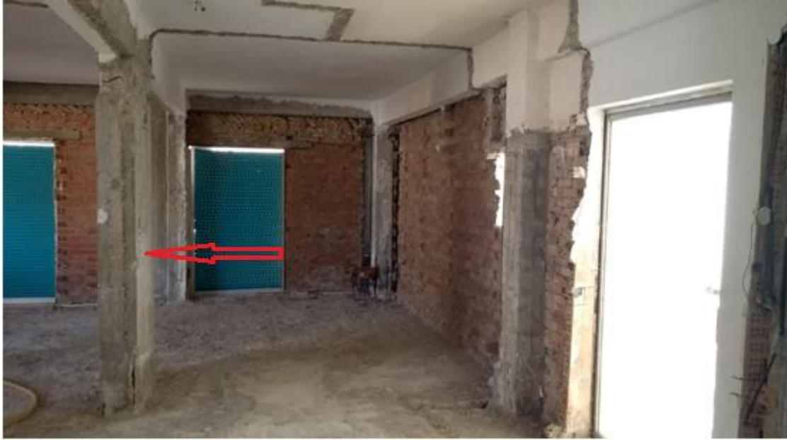
Σχήμα 6. 5: Ένα από τα υποστολώματα που χρίζει επισκευής – 800*200mm (Πηγή: Αρχείο συγγραφέα)
