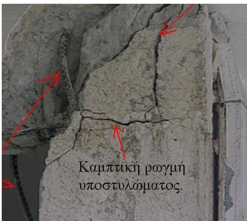
Σχήμα 2. 3: Καμπτική αστοχία υποστυλώματος (Πηγή: http://ecourses.dbnet.ntua.gr/9421.html )
