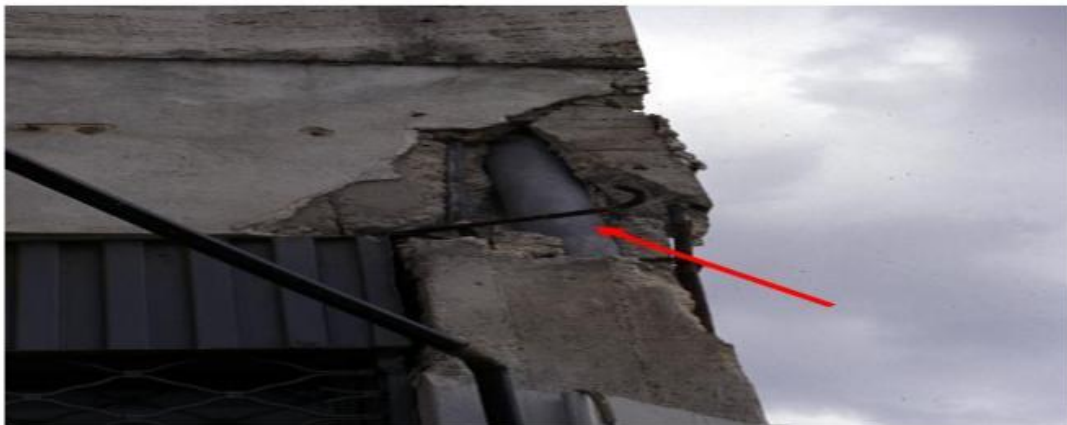
Σχήμα 2. 8: Αστοχία κόμβου και απόλεια περίσφιξης συνδετήρων λόγω τοποθέτησης υδρορροής εντός του υποστυλώματος
