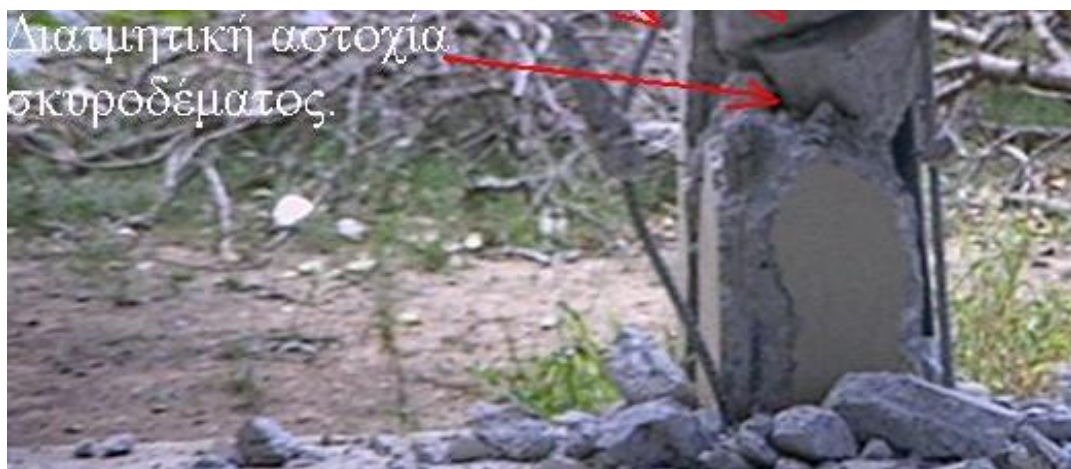
Σχήμα 2. 4: Διατμητική αστοχία υποστυλώματος (Πηγή: http://ecourses.dbnet.ntua.gr/9420.html )
