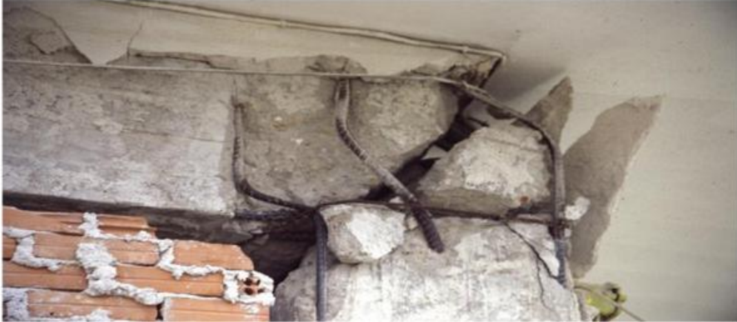
Σχήμα 2. 7: Αστοχία εξωτερικού κόμβου και πρακτική απόλεια στήριξης
