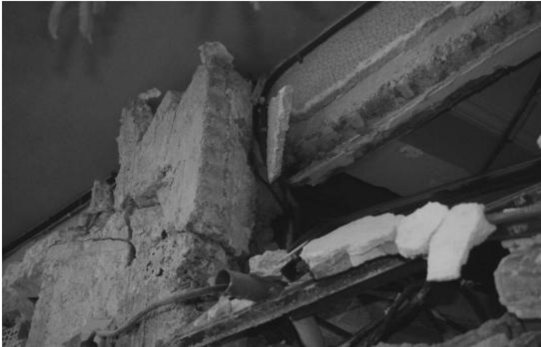
Σχήμα 2. 6: Βλάβη κόμβου μεταξύ υποστυλώματος και συντρέχουσες δοκούς 4
