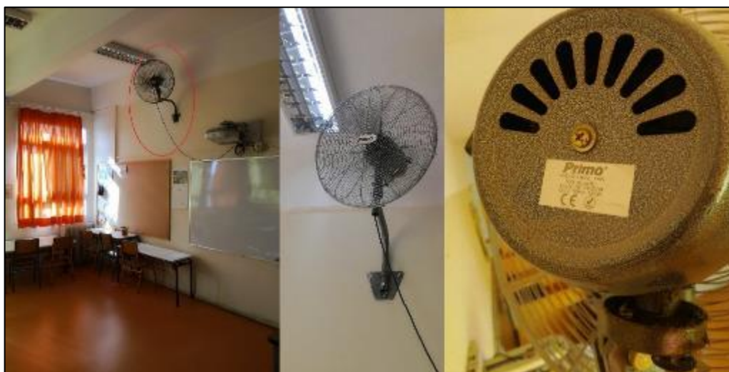
Εικόνα 17: Ο ανεμιστήρας "ανάδευσης". Θέση τοποθέτησης, χαρακτηριστικά.
