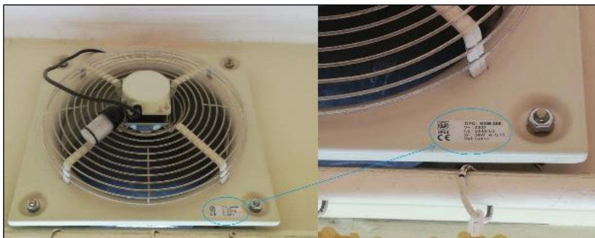
Εικόνα 15: Ένας από τους δυο όμοιους ανεμιστήρες εξαγωγής αέρα του τοίχου. Στη λεπτομέρεια δεξιά τα κατασκευαστικά του χαρακτηριστικά.
