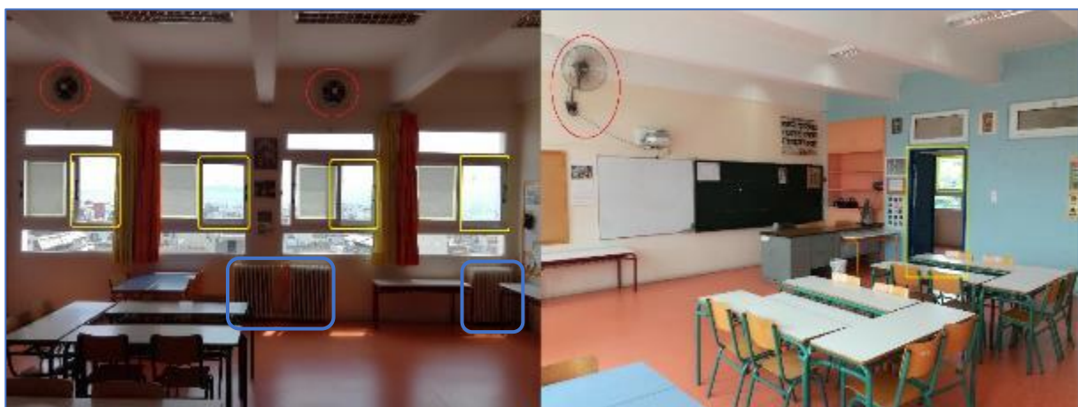
Εικόνα 14: Δριστερά: οι ανοιγόμενες επιφάνειες των παραθύρων (σημειωμένες με κίτρινο). Οι ανεμιστήρες τοίχου εξαγωγής αέρα (με κόκκινο) και με μπλε τα 3 σώματα θέρμανσης (καλοριφέρ). Δεξιά: Η πόρτα της αίθουσας ανοιχτή (με κίτρινο). Έχει σημειωθεί και το παράθυρο του διαδρόμου με το οποίο δημιουργείται ρεύμα (με πράσινο). Ο ανεμιστήρας «ανάδευσης» του υπέρχοντος αέρα (με κόκκινο).
