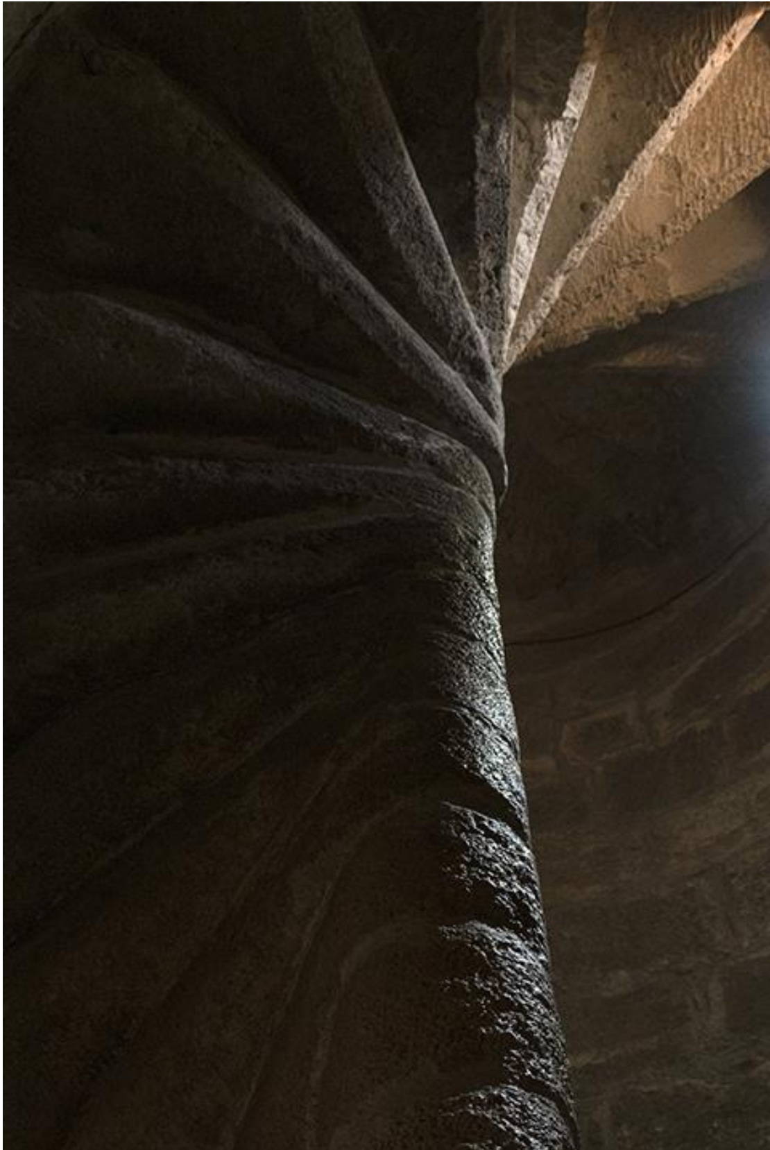
ΕΙΚΟΝΑ 51 ΕΣΩΤΕΡΙΚΕΣ ΣΚΑΛΕΣ, ΟΠΟΥ ΕΝΩΝΟΥΝ ΤΟΝ ΠΡΩΤΟ ΟΡΟΦΟ ΜΕ ΤΟΝ ΔΕΥΤΕΡΟ ΚΑΙ ΤΗΝ ΤΑΡΑΤΣΑ. ©ΧΡΥΣΤΑΛΛΑ ΚΟΥΑΛΗ
