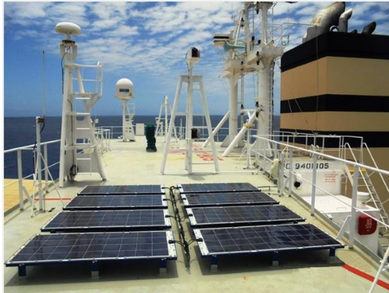
Εικόνα 3-10: Εγκατάσταση φωτοβολταϊκού συστήματος σε πλοίο general cargo/ container carrier (Πηγή No. 45)
