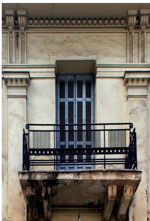
Εικόνα 5.1: Μπαλκόνι με φουρούσια του κτιρίου επί της οδού Τήνου αρ. 42
