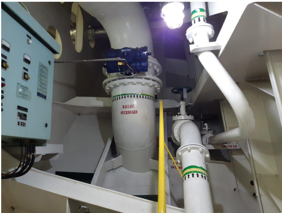
Εικόνα 24: Φωτογράφιση σημείων ενδιαφέροντος του δικτύου έρματος κατά την επίσκεψη συνεργείου αποτύπωσης του πλοίου μέσω 3D scanning. Εδώ παρατηρούμε μέρος του τελικού δικτύου απορροής έρματος στο χώρο του μηχανοστασίου (Port Side). Πιθανό σημείο τοποθέτησης δειγματοληψίας G2.
