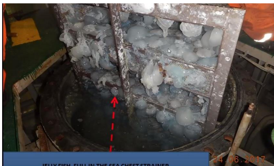
Εικόνα 2: Φίλτρο σχάρας εισαγωγής υδάτων έρματος γεμάτο από μέδουσες
