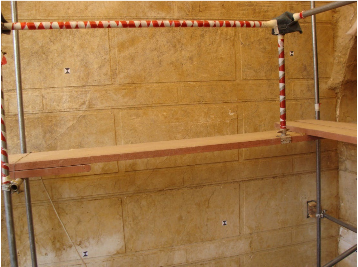
Εικόνα 25. Προσημασμένα φωτοσταθερά στον αριστερό πλευρικό τοίχο, στην είσοδο του τάφου.
