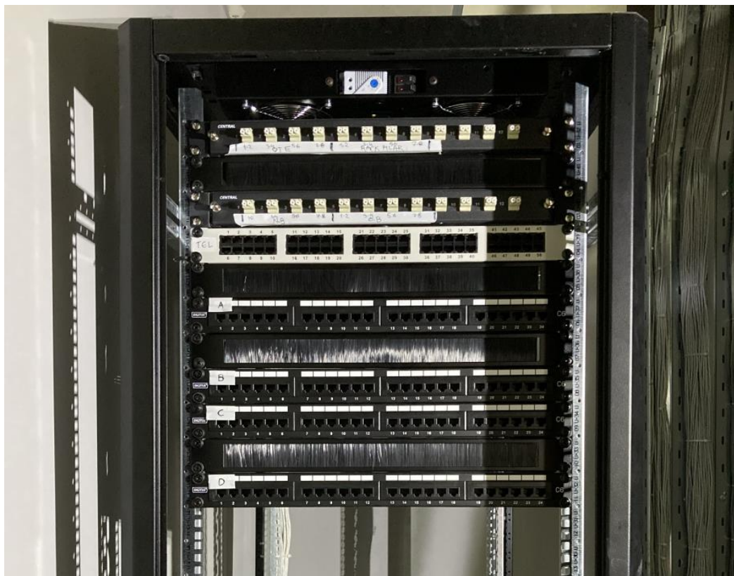
Εικόνα 16 - Εγκατάσταση Rack για δομημένη καλωδίωση, CCTV και πυρανίχνευση
