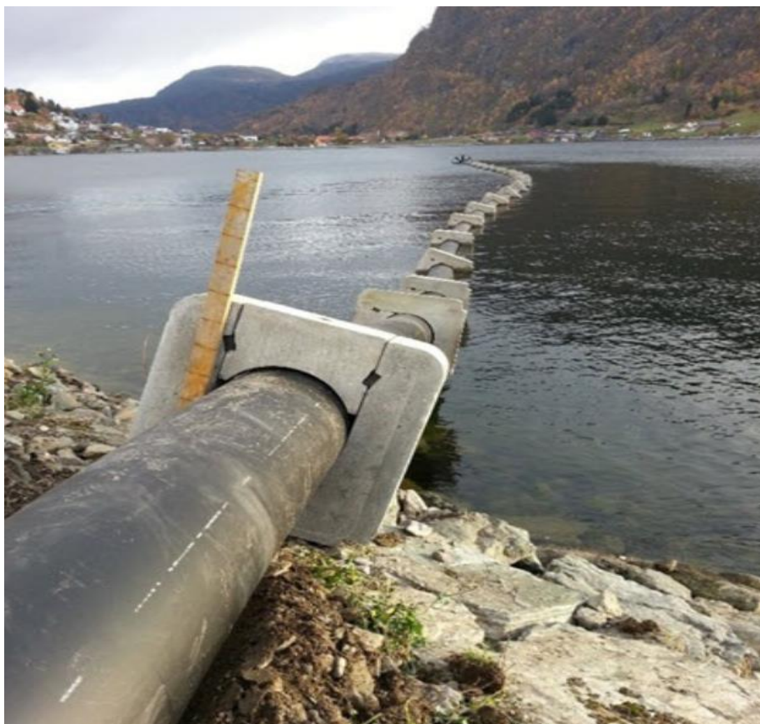
Εικόνα 10-Σωλήνας πρόσληψης θαλασσινού νερού [4]
