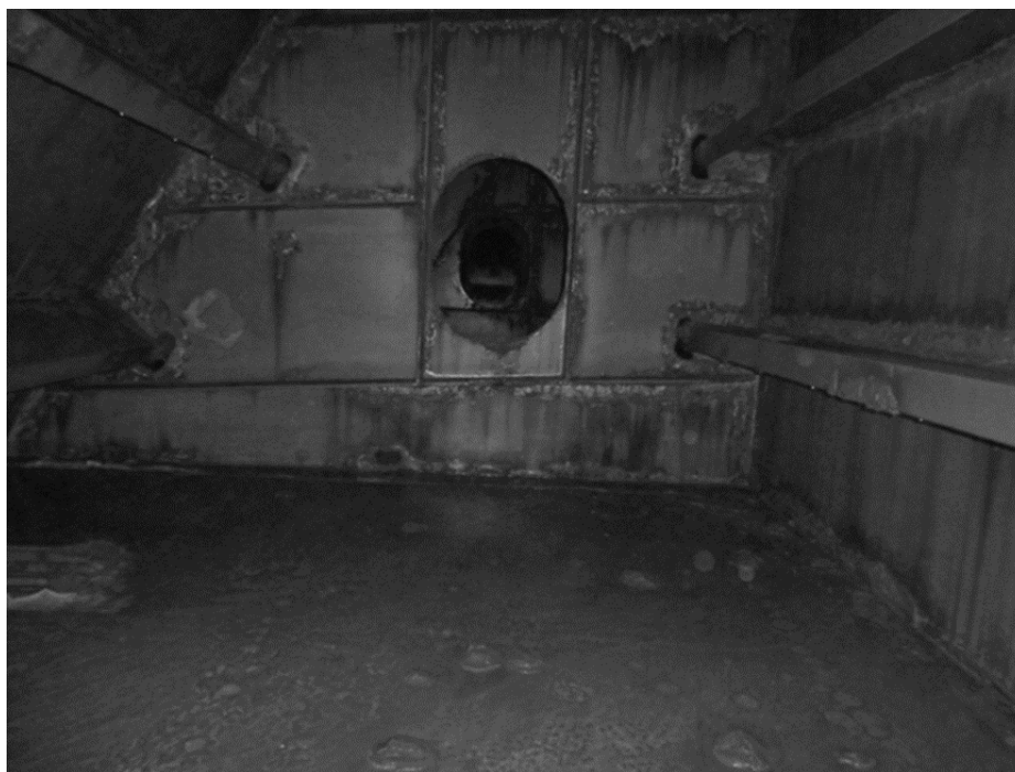
Εικόνα 29: Εμφανιση διάβρωσης σε δεξαμενή έρματος.
