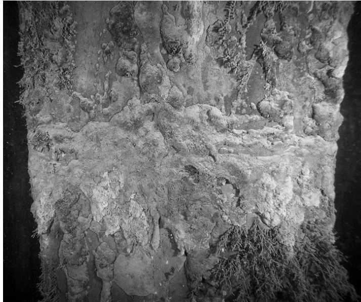
Εικόνα 28: Βακτηριακή διάβρωση ( bacterial corrosion ). ( https://micans.se/microbial-corrosion )
