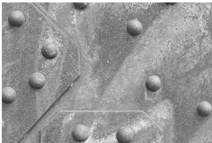
Εικόνα 24: Ομοιόμορφη διάβρωση ( general corrosion ). ( https://www.thoughtco.com/types-of-corrosion-2340005 )
