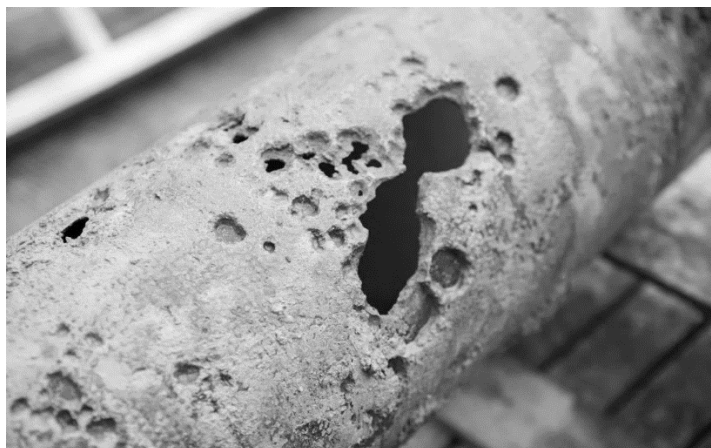
Εικόνα 25: Διάβρωση με βελονισμούς ( pitting corrosion ).
