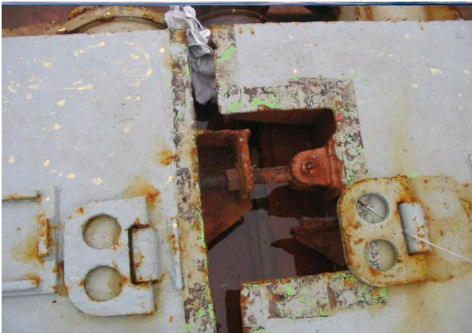
Εικόνα 12. Διάβρωση σε εξαρτήματα σύσφιξης και ράβδους συγκράτησης των καλυμμάτων (Mayor 2013a).
