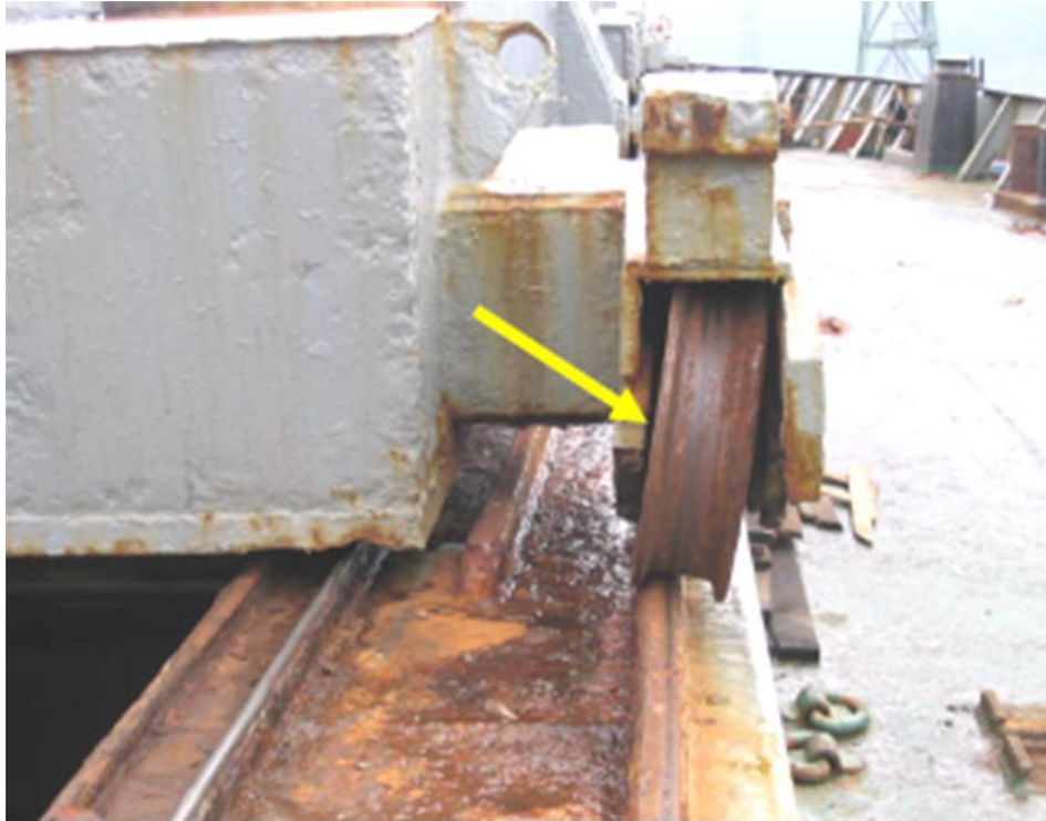
Εικόνα 11. Διάβρωση σε ράγες οδήγησης και τροχούς που βοηθούν στην κίνηση των καλυμμάτων (Mayor 2013a).
