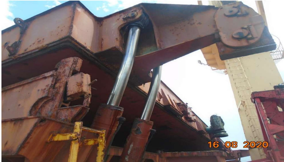
Εικόνα 16. Σημάδια διάβρωσης κυλίνδρου ανύψωσης καλύμματος (πηγή: Alatas Singapore Pte Ltd. 2020).
