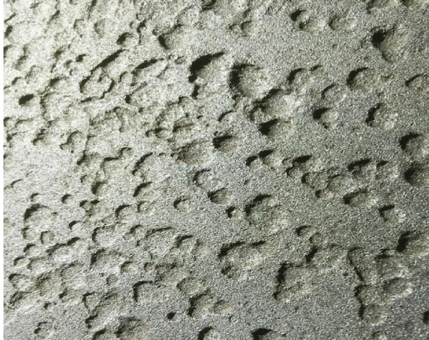
Εικόνα 2. Διάβρωση με βελονισμούς (πηγή: Glister 2017).
