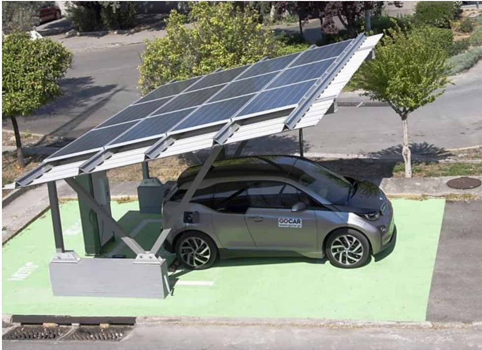
Εικόνα 2.21 Σταθμός φόρτισης ηλεκτρικών οχημάτων ΠΑ.Δ.Α
