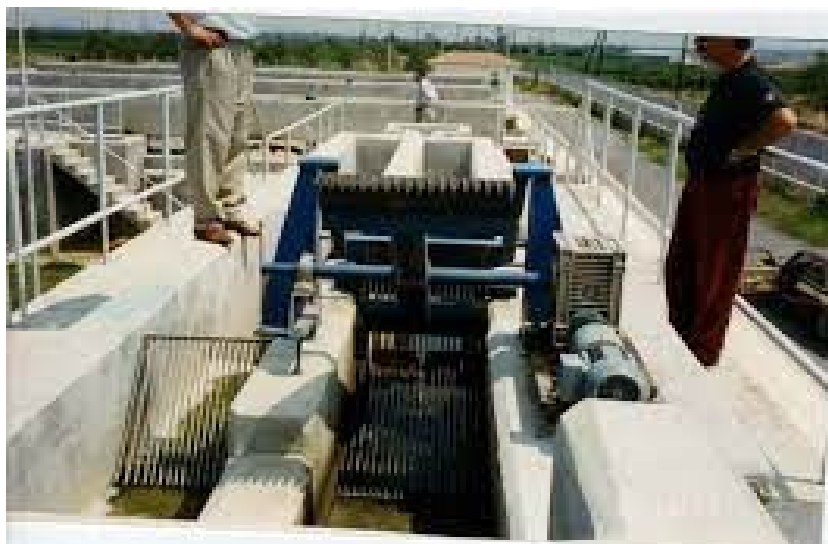
Εικόνα 2.1: Διαδικασία Προ-επεξεργασία. Χειροκαθαριζόμενη και μηχανική τοξωτή σχάρα (Προεπεξεργασία, 2006).
