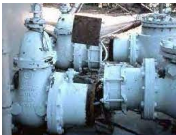
Εικόνα 3.19: Αποκομμένος σωλήνας μετά από έντονες σεισμικές δονήσεις σε εγκατάσταση επεξεργασία λυμάτων (EPA Office of Water, 2018).
