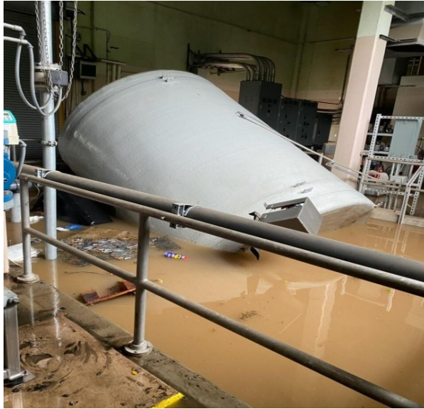
Εικόνα 3.17: Αστοχία δεξαμενής μετά από πλημμύρα στη Φιλαδέλφεια ( DanSokil, 2020).
