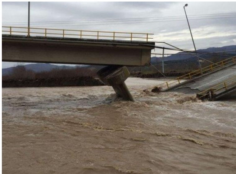
Μετατόπιση μεσοβάθρου λόγω υποσκαφής
