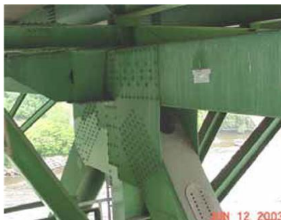
Λυγισμός κομβοελασμάτων του φορέα U10
