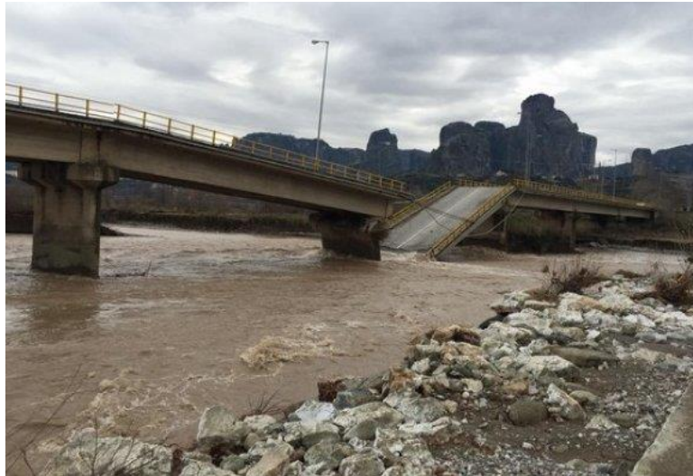
Η Γέφυρα μετά από τη κατάρρευση
