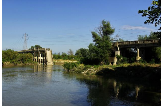
Η Γέφυρα μετά από τη κατάρρευση
