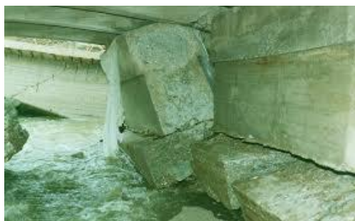
Μετατόπιση μεσοβάθρου στο χείμαρρο Ζηλιάνα λόγω υποσκαφής
