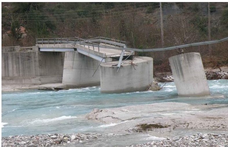
Γέφυρας η οποία είχε καταρρεύσει επί του Αχελώου ποταμού, και επί της οδού που συνδέει το Γκολφάρι Μυροφύλλου με την Εθνική οδό Τρικάλων – Άρτας, λόγω υποσκαφής των βάθρων της, κατά την πλημμύρα του Νοεμβρίου του 2010.
