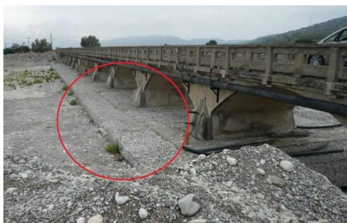
Γέφυρα Μάκαρη – Εργασίες προστασίας θεμελίων πριν την κατάρρευση
