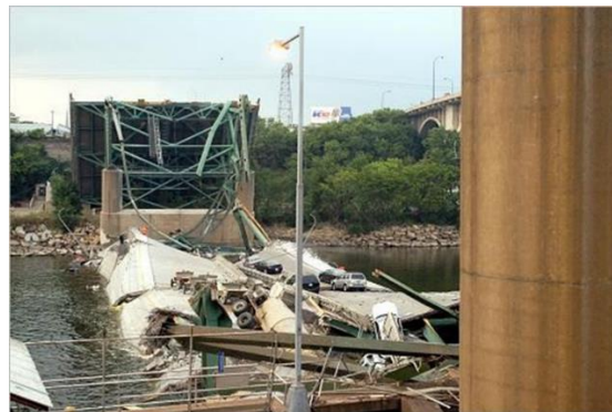
Η Γέφυρα μετά την κατάρρευση
