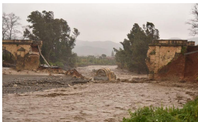
Η Γέφυρα μετά από τη κατάρρευση
