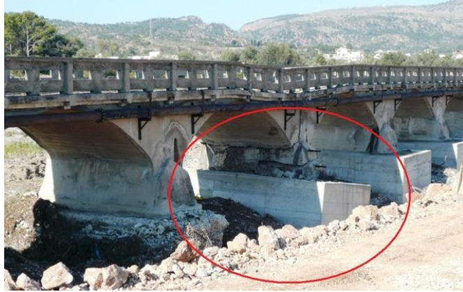
Γέφυρα Μάκαρη – Καθίζηση πέλδλου
