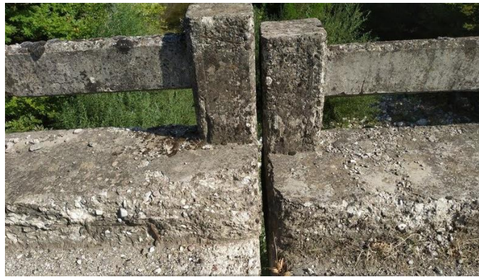
Η κατάσταση της γέφυρας πριν την κατάρρευση (Αύγουστος 2020)
