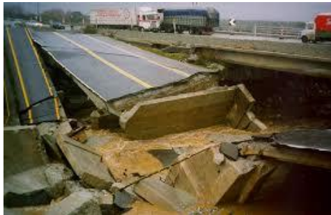
Η Γέφυρα μετά από τη κατάρρευση στο χείμαρρο Ζηλιάνα
