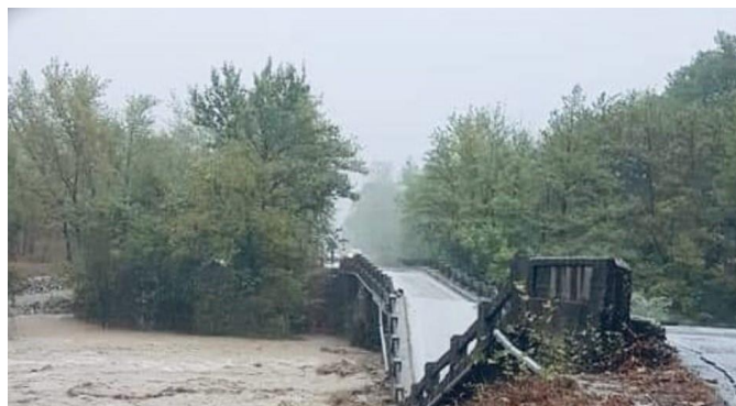
Η κατάρρευση της γέφυρας (Σεπτέμβριος 2020)
