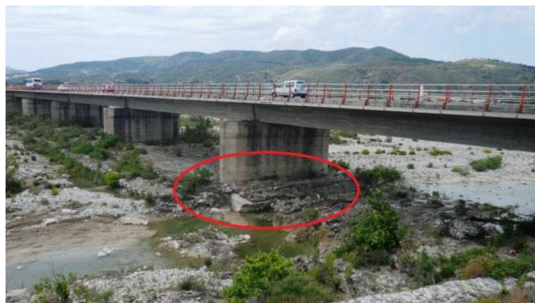
Γέφυρα Γαδουρά – Πέδιλο θεμελίωσης υποσκαπτόμενο
