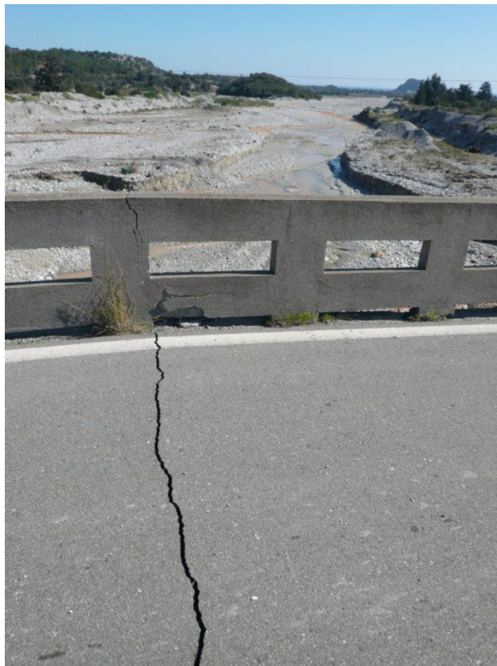
Γέφυρα Μάκαρη – Ρωγμή στο οδόστρωμα
