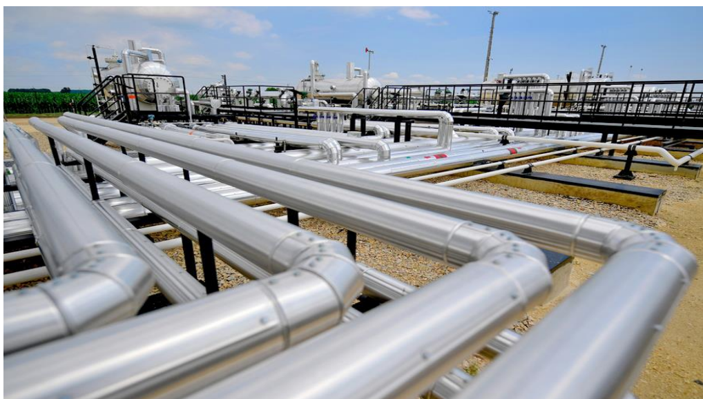
Εικόνα 14: Αγωγός φυσικού αερίου σε μονάδα στο Κιλκίς (πηγή: Energy In – Φυσικό αέριο, energyin.gr )
