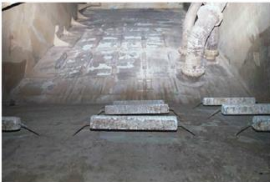
Εικόνα 10. Θυσιαζόμενες άνοδοι στον πυθμένα δεξαμενής. Provided by Larus S.A.
