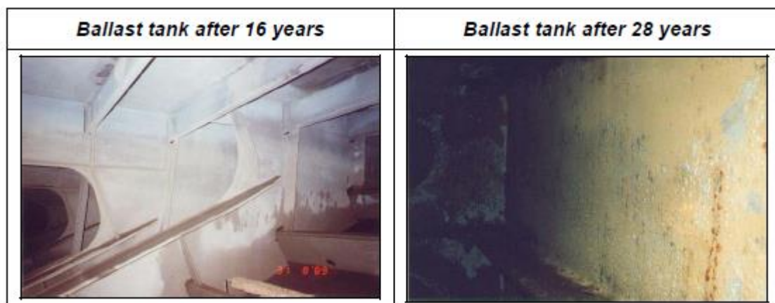
Εικόνα 12. Κατάσταση διάβρωσης δεξαμεμών έρματος στο πέρας του χρόνου.
