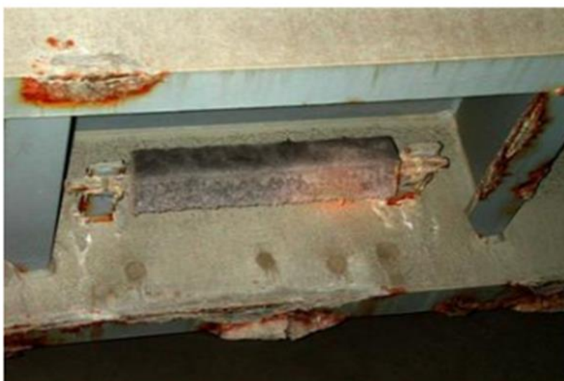
Εικόνα 4. Παράδειγμα τοπικής διάβρωσης του υποστρώματος σε WBT με λάθος τοποθετημένη άνοδο σε κλειστή περιοχή της δεξαμενής.
