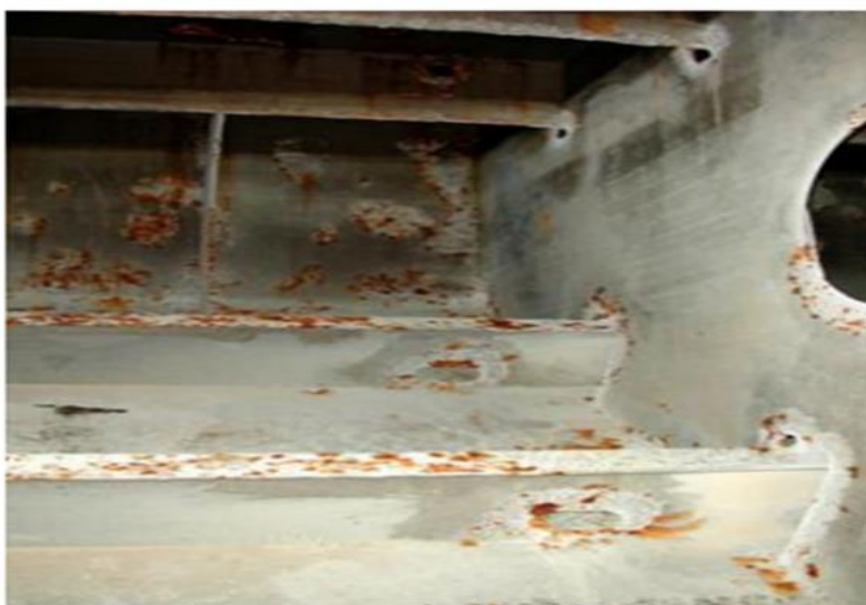
Εικόνα 3. Παράδειγμα τοπικής διάβρωσης του υποστρώματος σε WBT ως συνέπεια τοπικού σπασίματος επιχρίσματος κοντά σε αποκόμματα και συγκολλήσεις.
