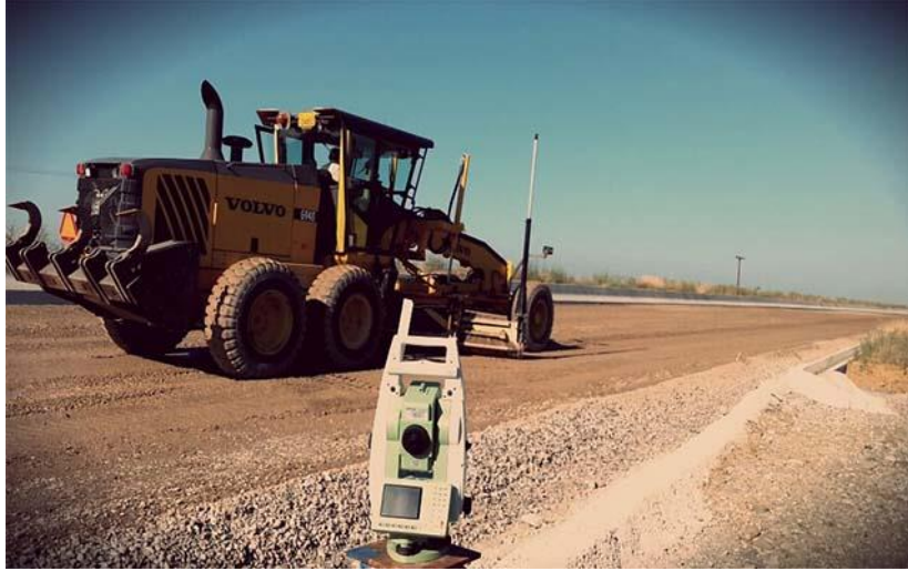
Εικόνα 56:3D system με χρήση ρομποτικού σταθμού
