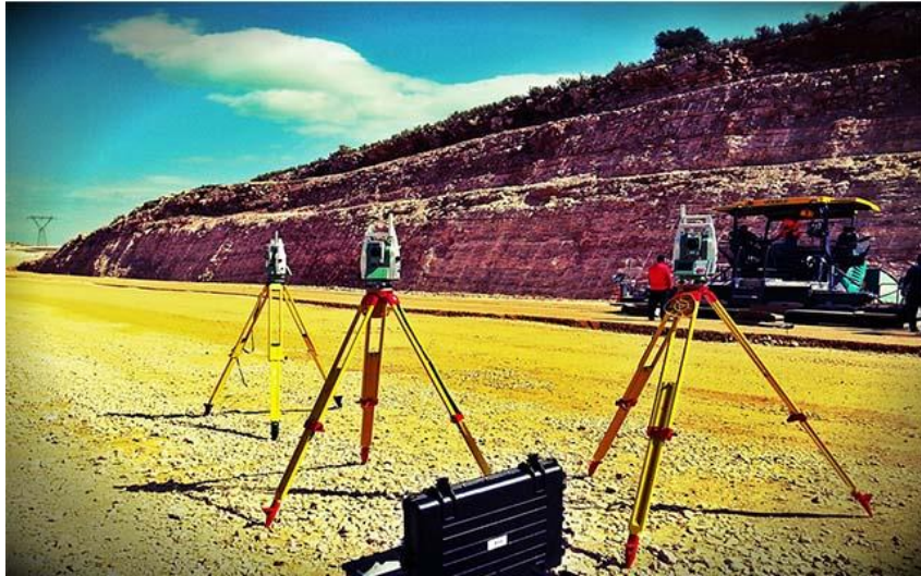
Εικόνα 72:Γεωδαιτικοί σταθμοί απαραίτητοι για την υλοποίηση του έργου
