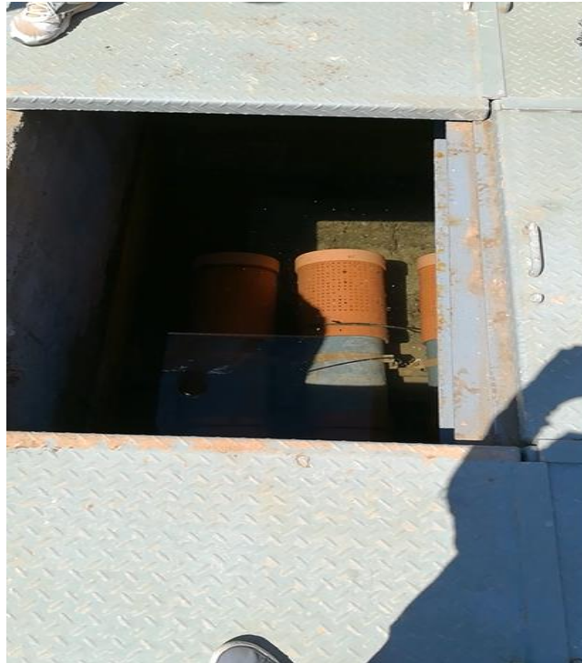
Εικόνα 3.17 Φρεάτιο συλλογής θαλασσινού νερού και φιλτράρισμα ευμεγεθών αντικειμένων
