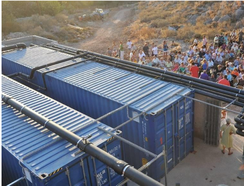
Εικόνα 3.15 Εμπορευματοκιβώτιο μονάδων αντίστροφης ώσμωσης
