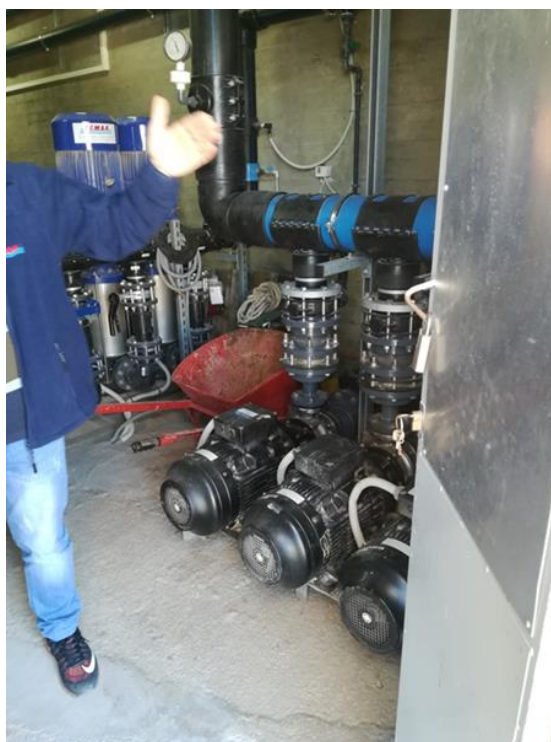
Εικόνα 3.16 Αντλίες τροφοδοσίας της μονάδας με θαλασσινό νερό
