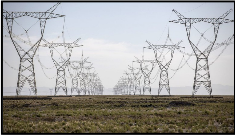
Εικόνα 5. Πυλώνες Υψηλής και Υπερουψηλής Τάσης – Ελλάδα
