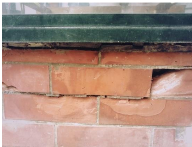
Εικόνα 18 Σπασμένο δομικό τμήμα της βιτρίνας.
