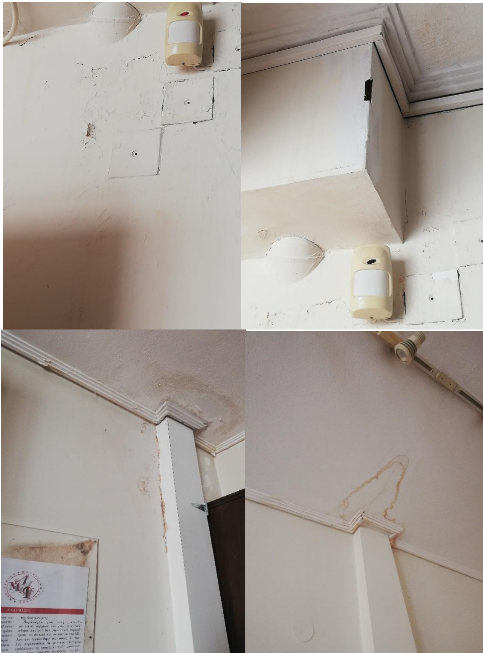
Εικόνα 52 Σημάδια υγρασίας στους τοίχους και οπές που έχουν δημιουργηθεί.
