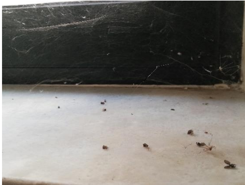
Εικόνα 28 Νεκρά μυγάκια και ιστοί αραχνών στο εσωτερικό περβάζι των παραθύρων.
