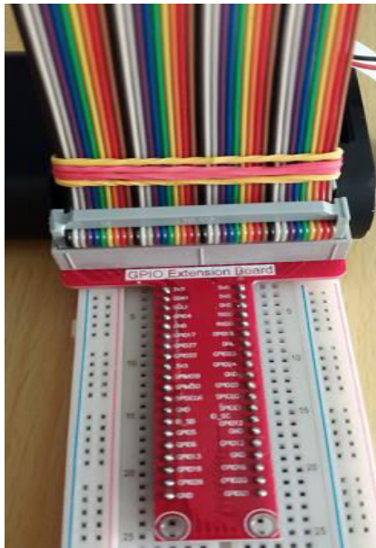
Εικόνα 4.25 GPIO πίνακα επέκτασης συνδεδεμένος με σειριακή διεπαφή GPIO
