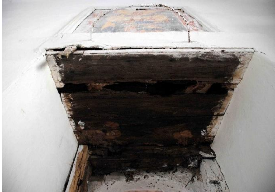
Εικ. 71: Αποσάθρωση ξύλινου κασσώματος
