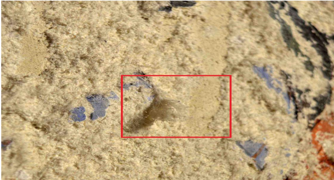
Εικ. 61: Απώλειες χρωματικού στρώματος και αποσάθρωση, μερική ή και ολική απώλεια επιφανειακού στρώματος επιχρίσματος, εξανθήσεις αλάτων. Η δέσμη ινών στο μέσον της εικόνας δεν είναι οργανικές ίνες που είχαν προστεθεί στη δομή του κονιάματος, αλλά εξανθήσεις αλάτων.
