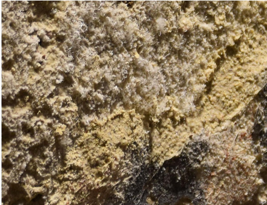
Εικ. 79: Εμφάνιση εξανθήσεων αλάτων δύομισι μήνες μετά τις επεμβάσεις αφαλάτωσης
