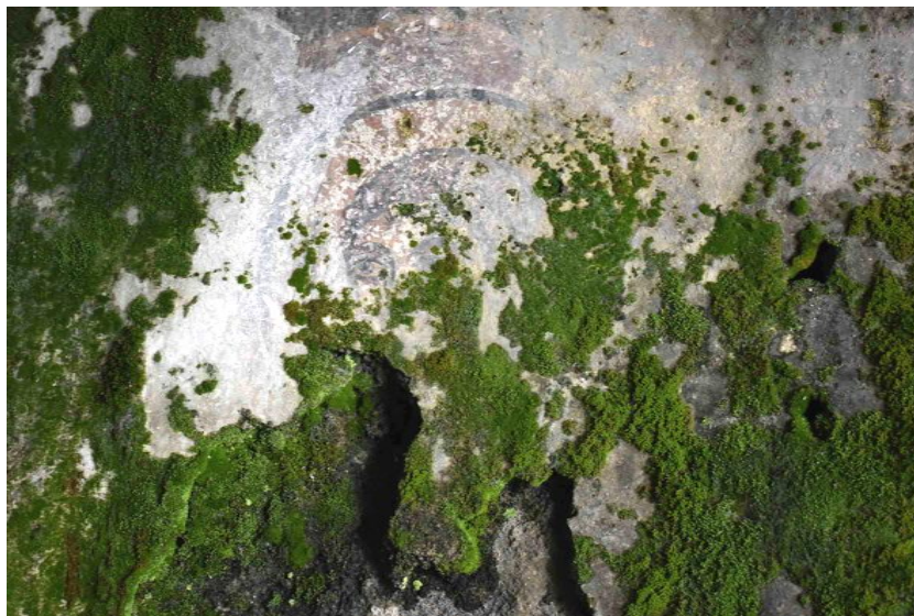
Εικ. 7: Αποσάθρωση και έκπλυση υποστρώματος, απώλειες χρωματικού στρώματος, κρούστα αλάτων και ανάπτυξη Βρύων
