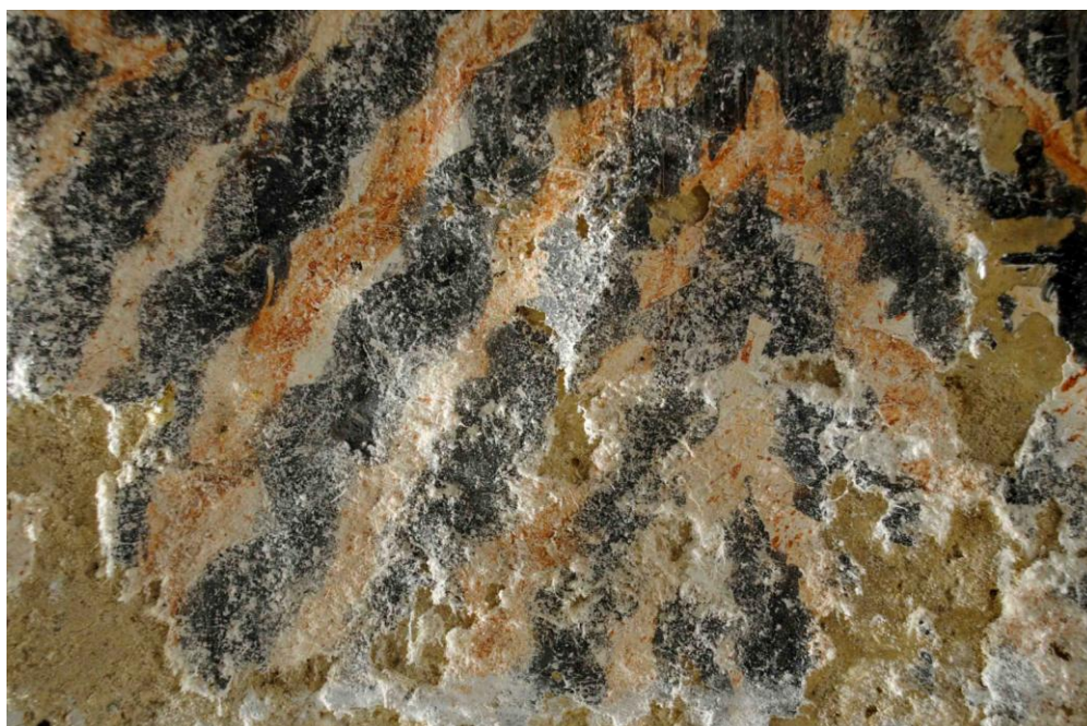
Εικ. 59: Αποκολλήσεις, απώλειες, αποσάθρωση, παραμόρφωση, πλήρης αποδιοργάνωση επιφανειακού υποστρώματος και χρωματικού στρώματος
