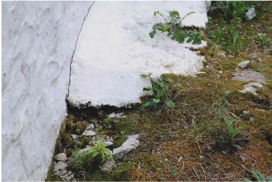
Εικ. 54: Ρωγμή μεταξύ κτιστού πάγκου και βόρειου τοίχου Η σχεδόν σύγχρονη κεράμωση είναι κατασκευαστικά άρτια και δεν εμφανίζει αστοχίες.
