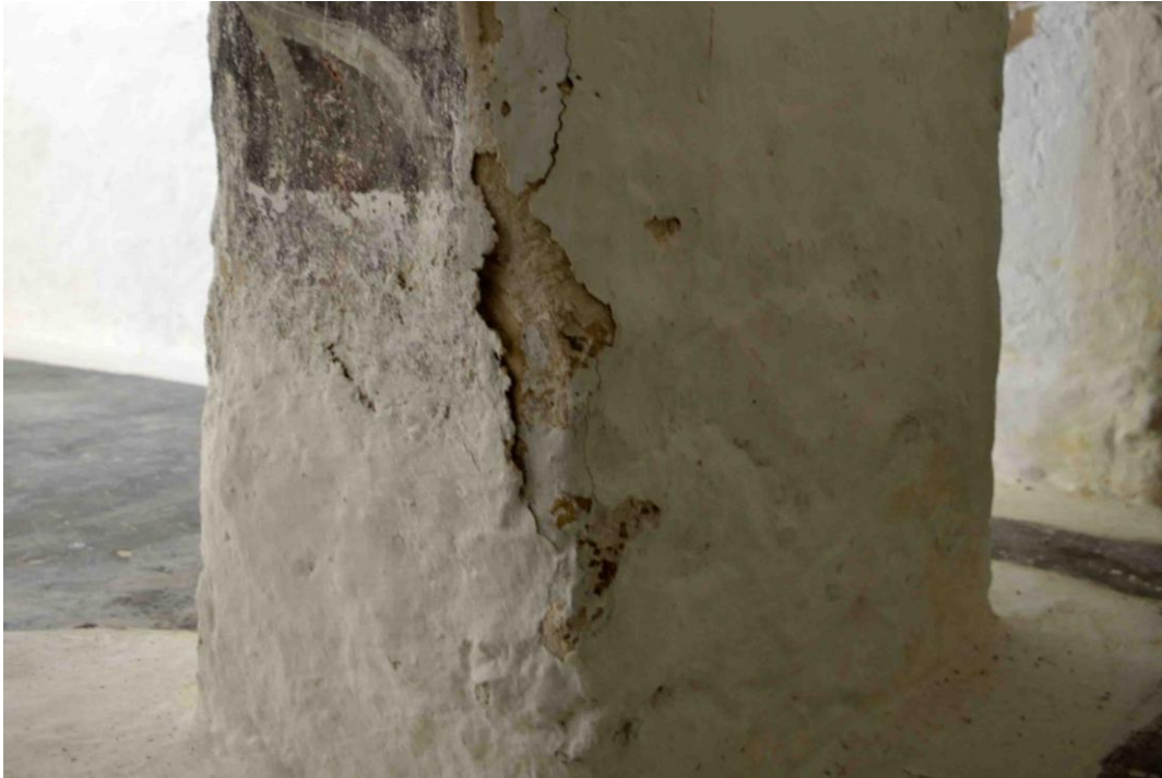
Εικ. 58: Αποκολλήσεις και απώλειες υποστρώματος
