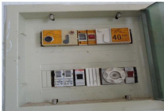
Κεντρικός ηλεκτρολογικός πίνακας
