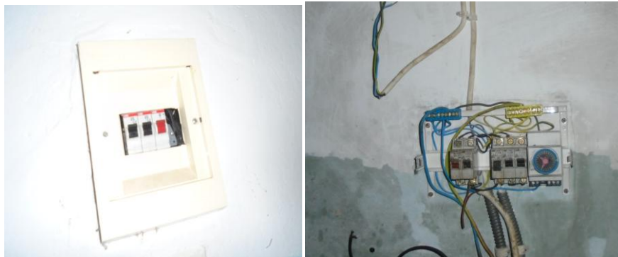
Ηλεκτρολογικοί Υποπίνακες ορόφου - λεβητοστασίου
