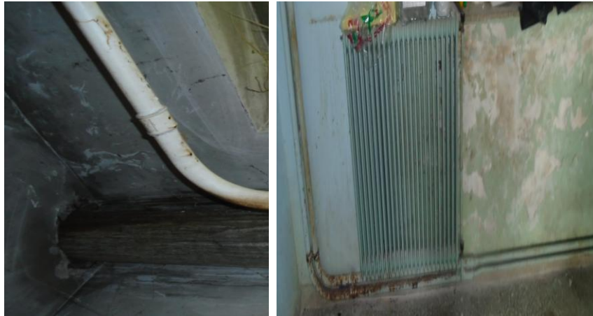
Σημάδια υγρασίας στο κτίριο
