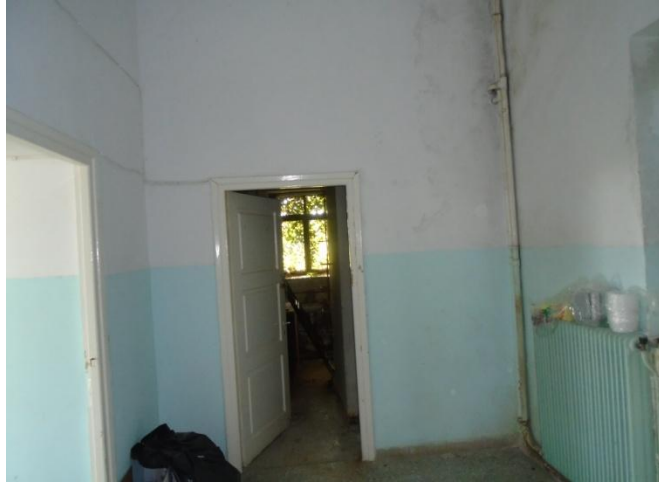
Είσοδος λεβητοστασίου (Χωλ 2)
