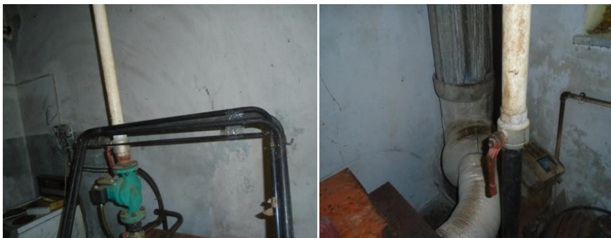
Κυκλοφορητής – σύνδεση καπνοδόχου
