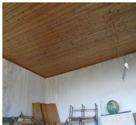
Σημάδια υγρασίας στην οροφή
