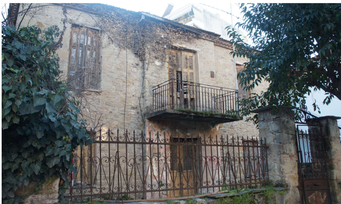
Εικόνα 20 : Εγκαταλελειμμένη κατοικία επί της οδού Αριστοτέλους ,πηγή : Δάσου Άννα ,Μάρτιος 2022
