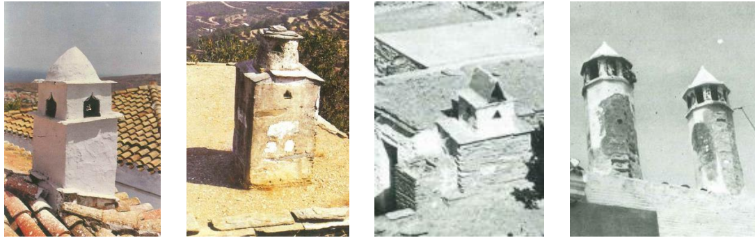
Εικόνα 33 : Καμινάδες στην Άνδρο σε διάφορα σχέδια και διατομές, πηγή : (Λυγίζος, Παλιά Αντρώτικα Σπίτια, 1983, σσ. 239,240,241)
