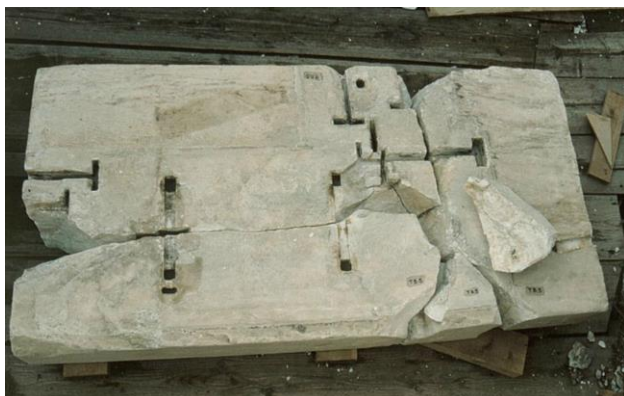
Εικ. 32: Θραύση μέλους λόγω διόγκωσης οξειδωμένων συνδέσμων από προηγούμενες αναστηλωτικές επεμβάσεις. Πηγή : Andro.gr, © ΥΣΜΑ, https://www.andro.gr/apopsi/acropole-balanos/
