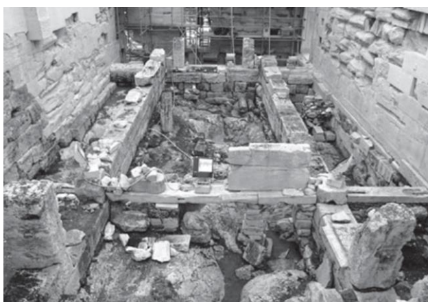
Εικ. 34: Το εσωτερικό του Ερεχθείου από την ανατολική πλευρά, πριν την επέμβαση. Πηγή: Κ. Μαμαλούγκας, 2013, © 2016 ΥΣΜΑ, https://workfun.openabekt.gr/files/items/7696218/P91.29.pdf
