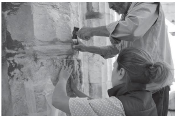
Εικ. 33: Εργασίες συντήρησης στην κιονοστοιχία της βόρειας πτέρυγας των Προπυλαίων. Πηγή: Π. Βλαχούλη, © 2016 ΥΣΜΑ, https://workfun.openabekt.gr/files/items/7696218/P91.29.pdf
