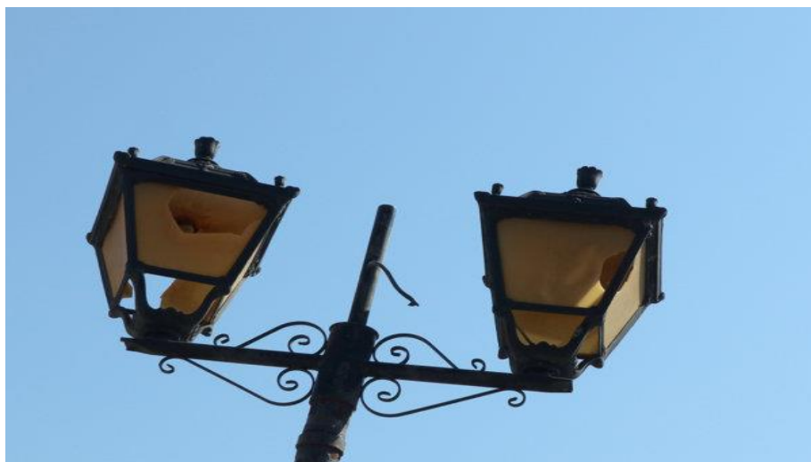
Εικόνα 12: κατασραμενο φωτιστικό σώμα εξωτερικού χώρου (bestoflarissa.gr, 2022)
