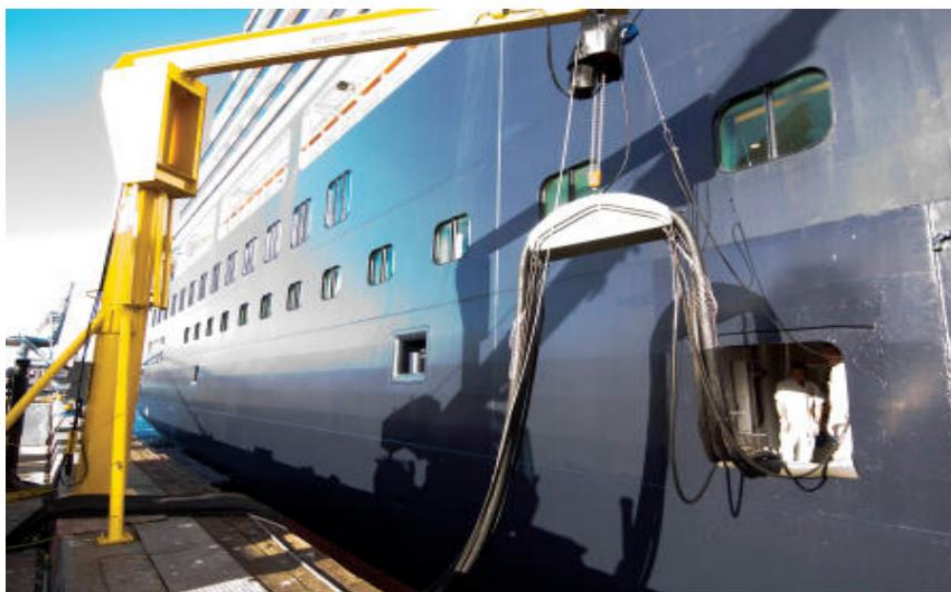
Εικόνα 3.1: Πλοίο κατά την διάρκεια ηλεκτρικής τροφοδότησης από την ξηρά.
