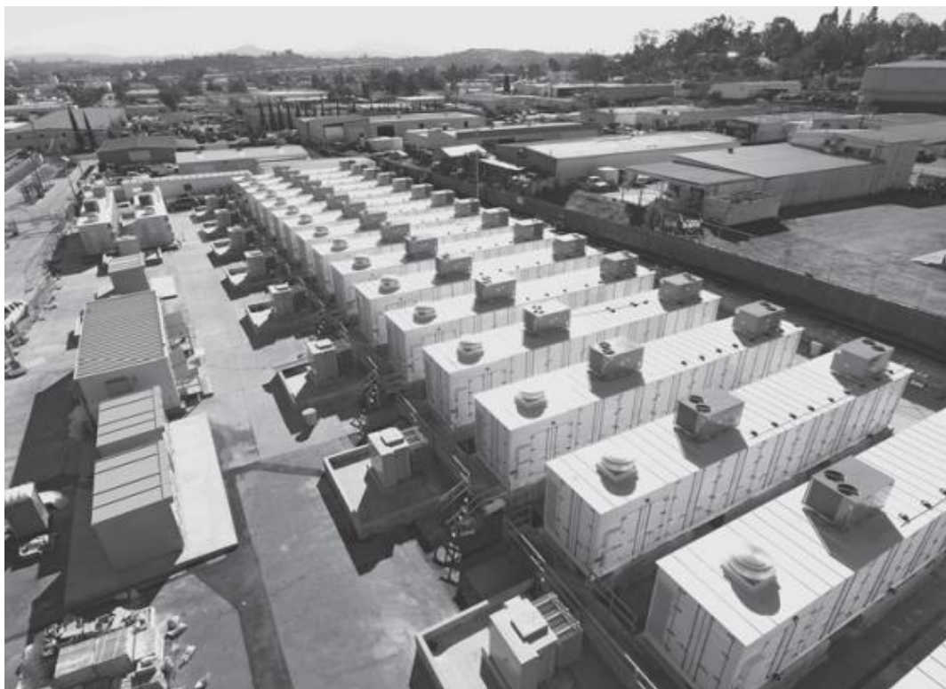
Εικόνα 2.6: Εγκατάσταση αποθήκευσης ισχύος 30 MW.
