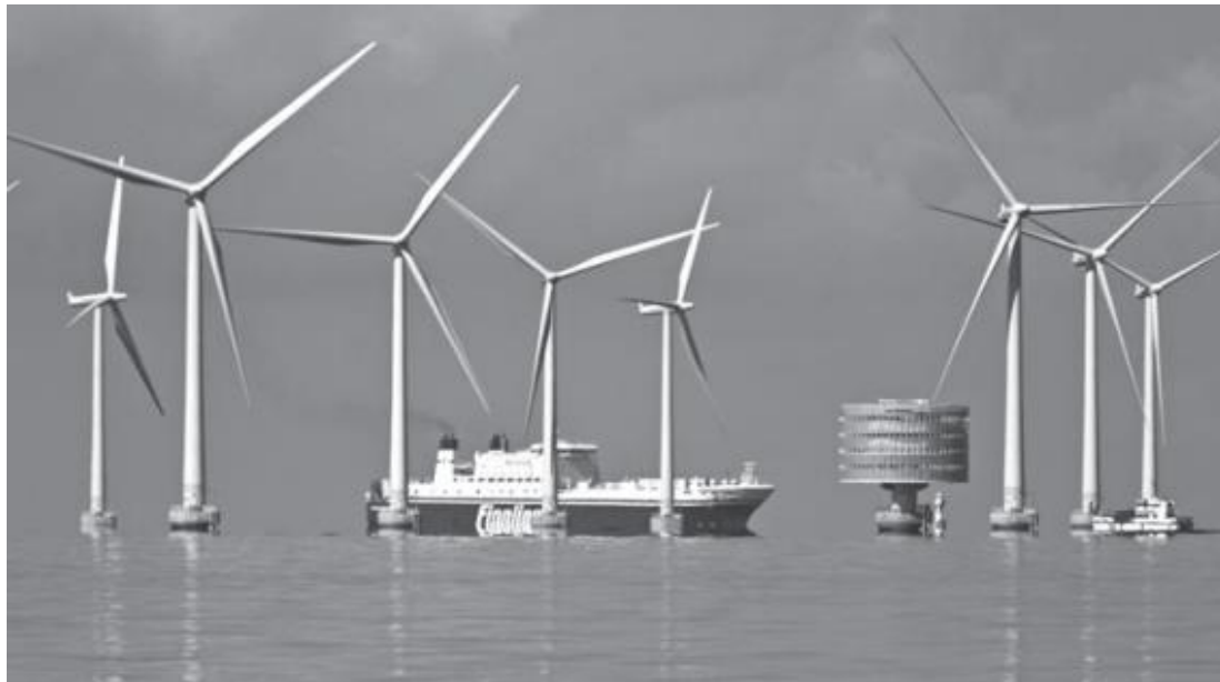
Εικόνα 2.1: Υπεράκτιο αιολικό πάρκο
