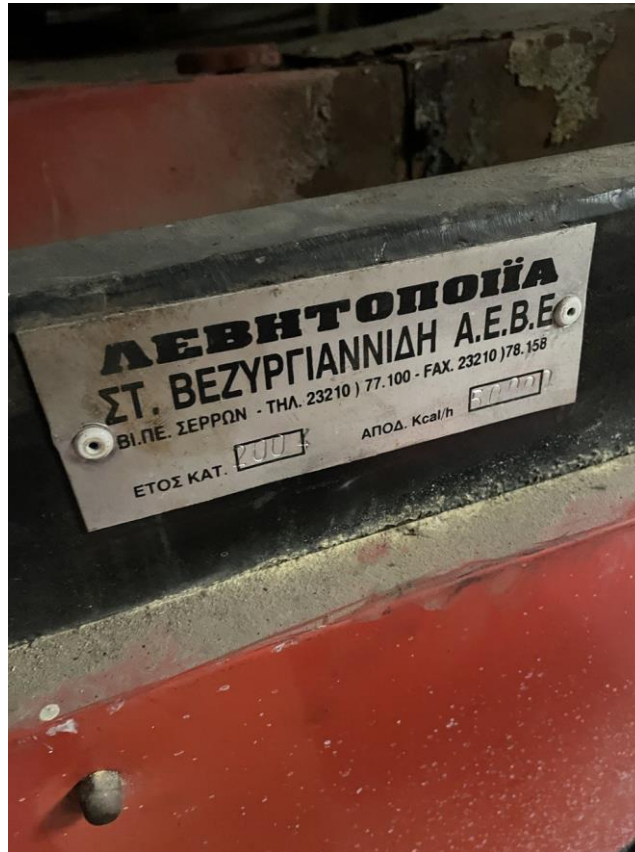
Εικόνα 24: Ετικέτα χαλύβδινου λέβητα με ονομαστική ισχύ και έτος κατασκευής
