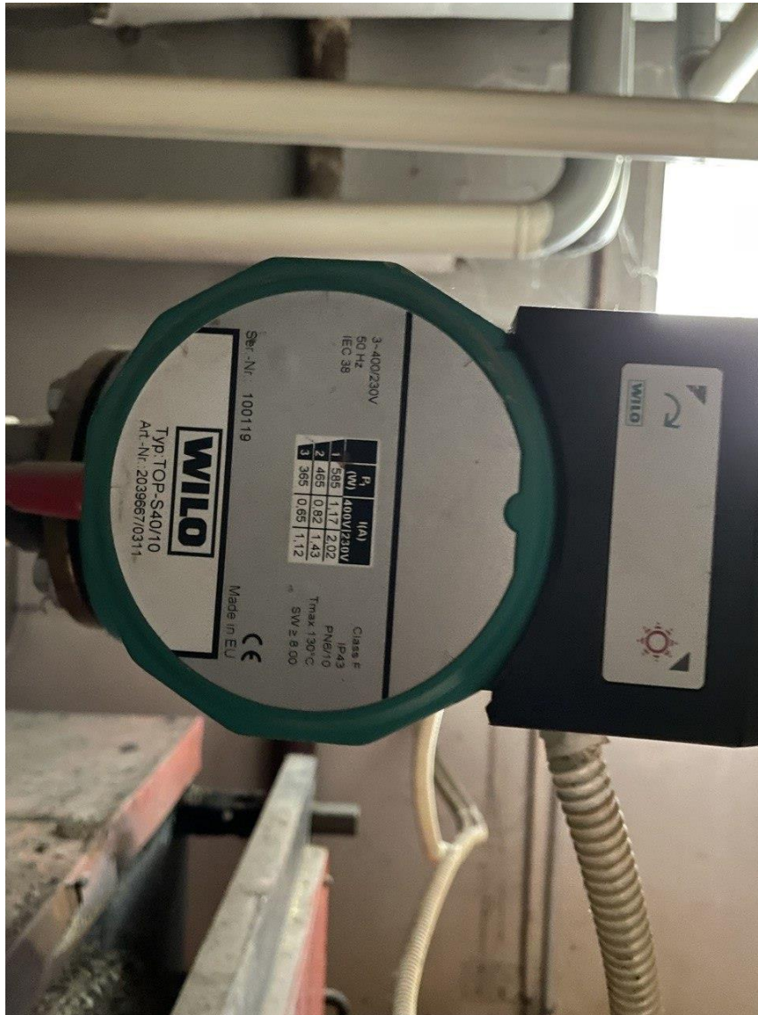
Εικόνα 28: Κυκλοφορητής δικτύου διανομής Θέρμανσης.
