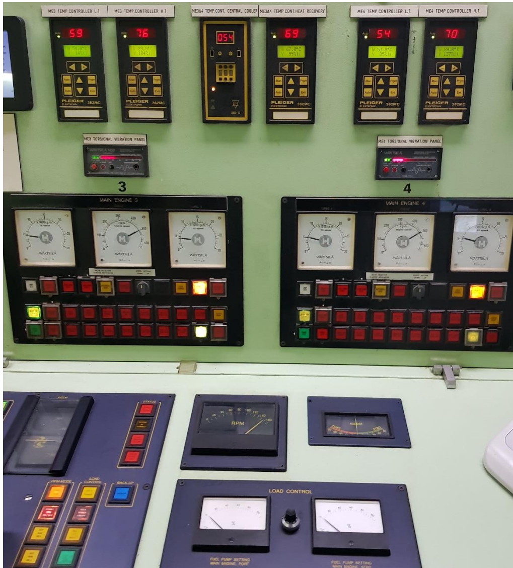
Σχήμα 3-9 Ενδείξεις οργάνων σε εγκατάσταση πλοίου με τέσσερις κύριες τετράχρορες μηχανές εσωτερικής καύσης.
