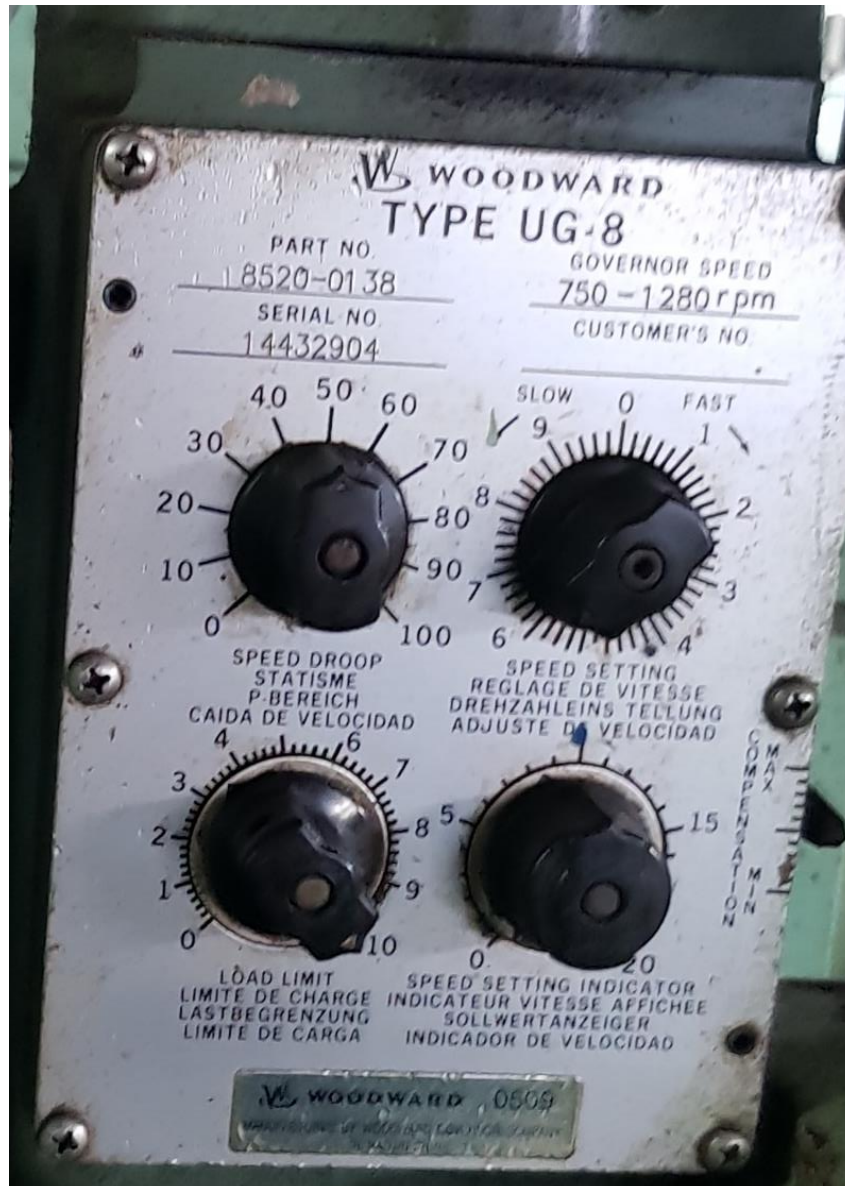
Σχήμα 3-8 Αυτόματος ρυθμιστής στροφών της Νο3 ηλεκτρομηχανής.
