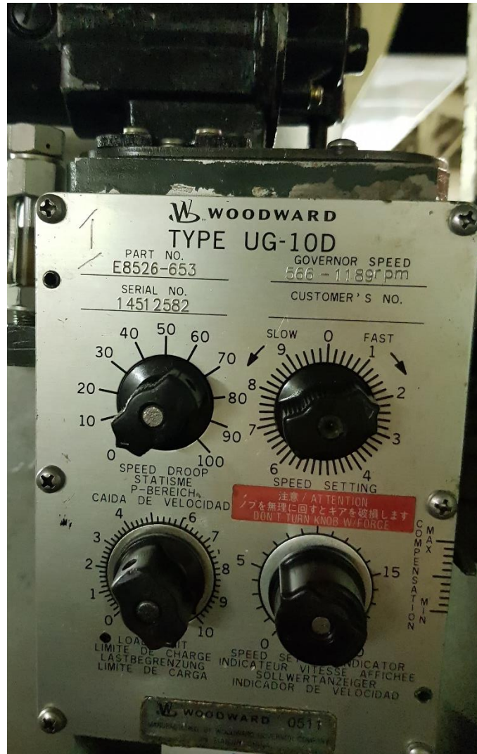
Σχήμα 13-2 Αυτόματος ρυθμιστής στροφών UG - 10D. Το ταμπελάκι των χαρακτηριστικών του δηλώνει πως λειτουργεί στο φάσμα με ταχύτητα περιστροφής από 566 έως 1189 στροφές / λεπτό. Σε αυτό το φάσμα λειτουργίας πρέπει να ρυθμιστεί όταν πραγματοποιηθεί η ρύθμιση του.
