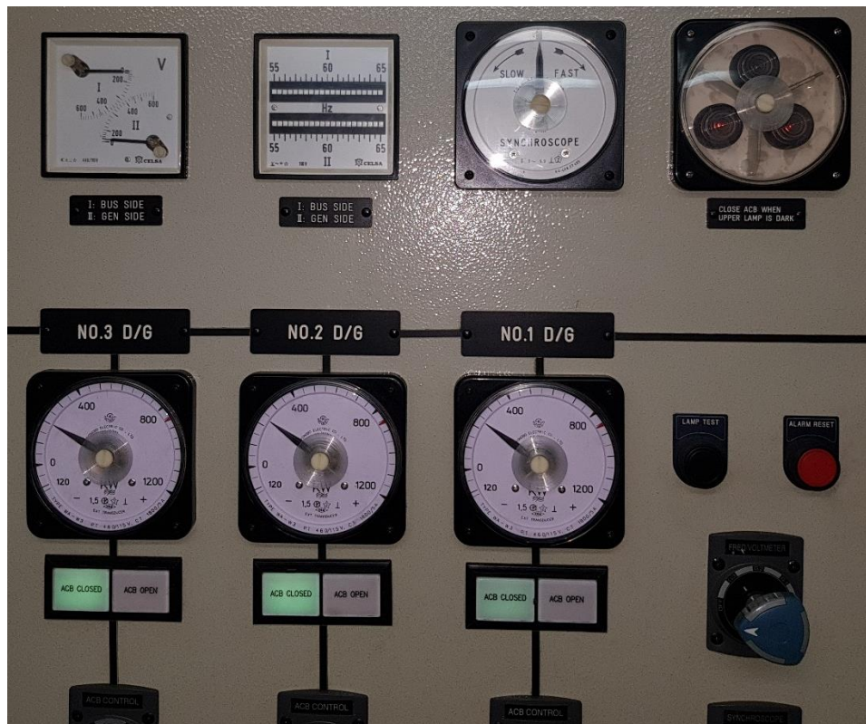
Σχήμα 3-5 Φωτό πάνελ ηλεκτρομηχανών ενώ είναι σε παράλληλη λειτουργία και οι 3 ταυτόχρονα. Διακρίνεται ο διαμοιρασμός του φορτίου με τα Kw να είναι ίδια και στις 3 ηλεκτρογεννήτριες (Ο όρος D/G σημαίνει Diesel Generator).
