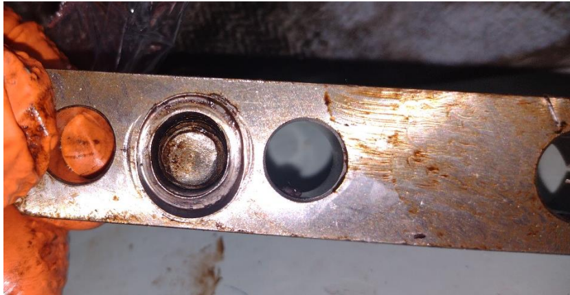
Σχήμα 12-8 Τερματικός σύνδεσμος (terminal bracket) με εκτεταμένη φθορά στην κεντρική οπή.
