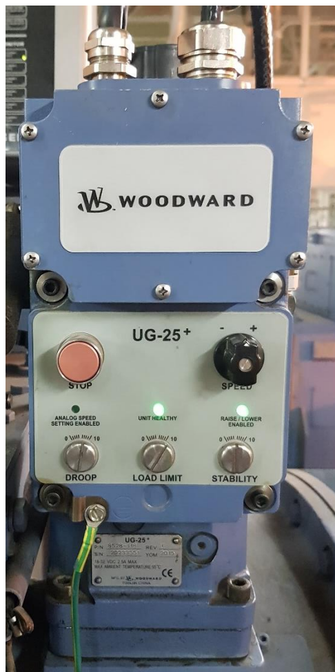
Σχήμα 8-1 Αυτόματος ρυθμιστής στροφών Woodward UG-25 + τοποθετημένος σε ηλεκτρομηχανή.
