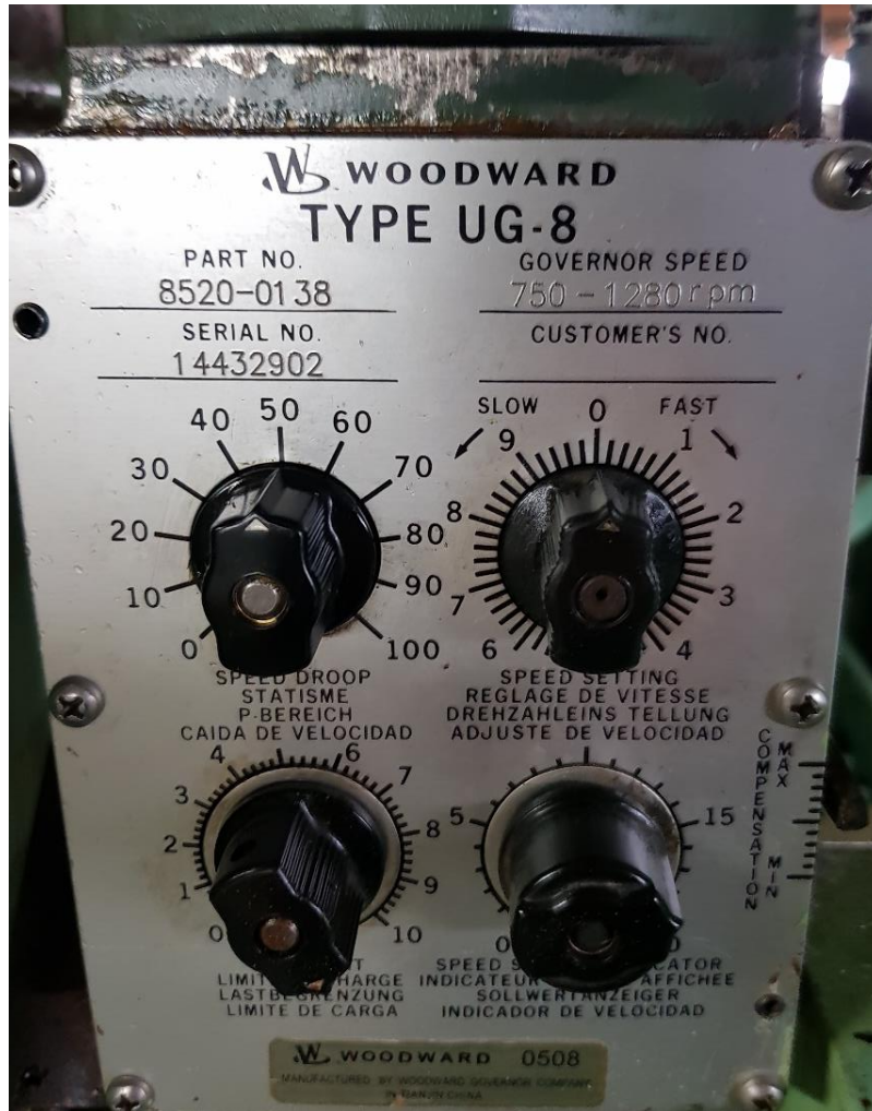
Σχήμα 3-7 Αυτόματος ρυθμιστής στροφών της Νο2 ηλεκτρομηχανής.
