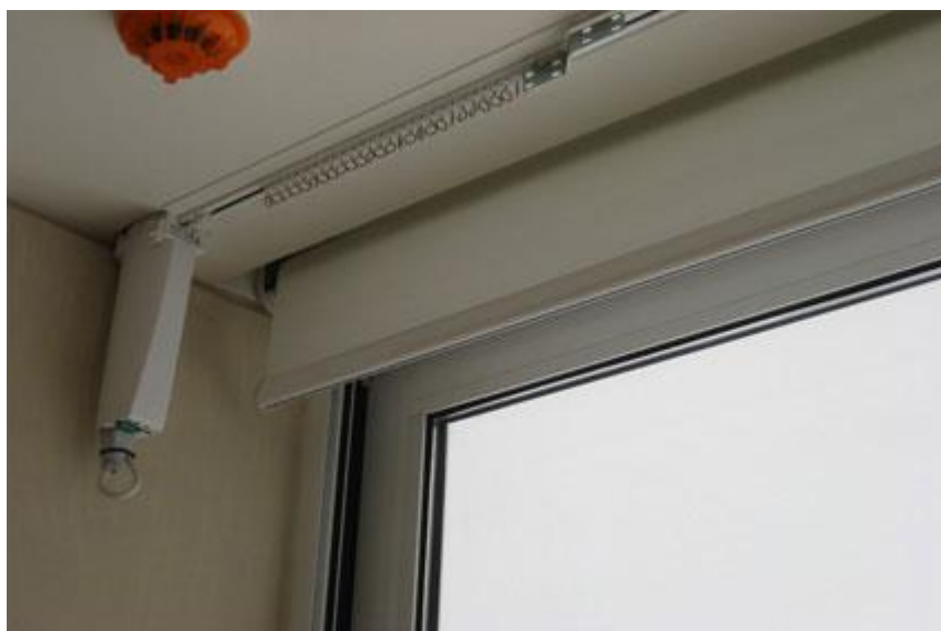
Εικόνα 7: Σύστημα διαχείρισης ρολών σε κατοικία(www.gds.com.gr, άλλες κατοικίες)
