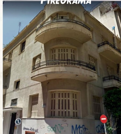
Εικ. 3: Το ίδιο οίκημα στη φωτογραφία πάνω όταν κατασκευάστηκε το 1935 και κάτω στην κατάσταση που βρίσκεται σήμερα (Συμβολή των οδών Φιλελλήνων και Περικλέους) – χαρακτηριστικό Έρκερ
