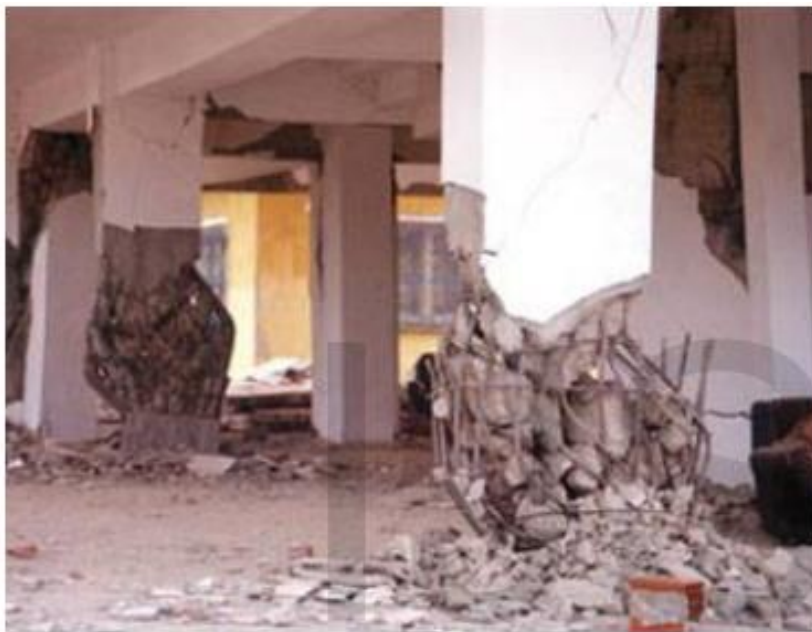
Εικόνα 2-22: Υποστυλώματα που έχουν υποστεί καμπτο-διατμητική βλάβη μετά από σεισμό με σύνθλιψη και λυγισμό των ράβδων οπλισμού
