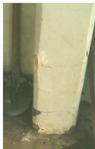
Εικόνα 2-18 : Μορφή παραμόρφωσης υποστυλώματος υπό πλευρικά φορτία (π.χ. σεισμικά) & καμπτικές ρωγμές στη βάση υφιστάμενου υποστυλώματος [8]
