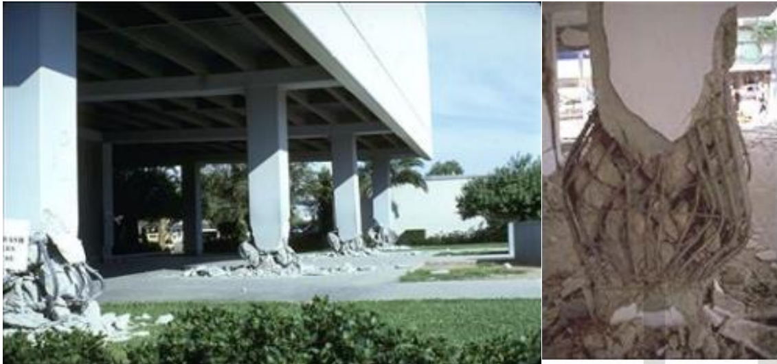
Εικόνα 2-27: Αστοχία ματίσεων στην βάση υποστυλωμάτων [8]
