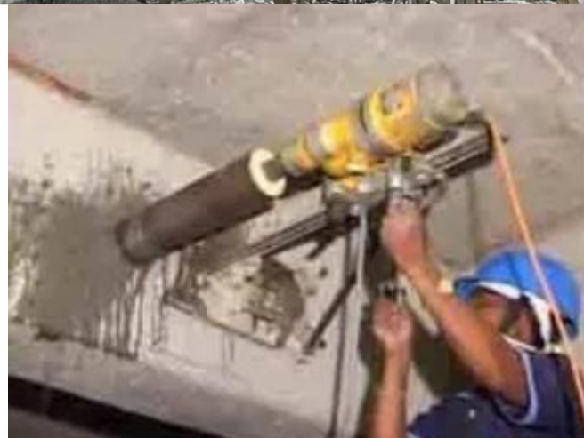
Εικόνα 1-1: Εφαρμογή ενίσχυσης υφιστάμενης κατασκευής (πάνω). Ποιοτικός έλεγχος δοκού με αποκοπή πυρήνα σκυροδέματος (κάτω)
