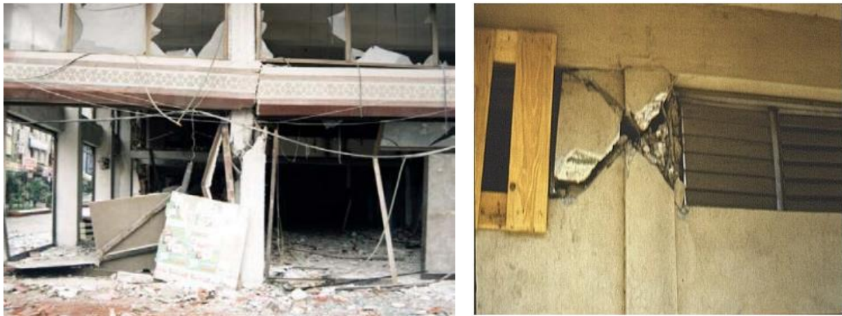
Εικόνα 2-20: Εμφάνιση διατμητικής αστοχίας σε υποστύλωμα (σεισμός Μαρμαρά 1999 [8]) & χαρακτηριστική χιαστί διατμητική ρωγή σε υποστύλωμα που συμπεριφέρεται ως κοντό διπλά από φεγγίτη [12]
