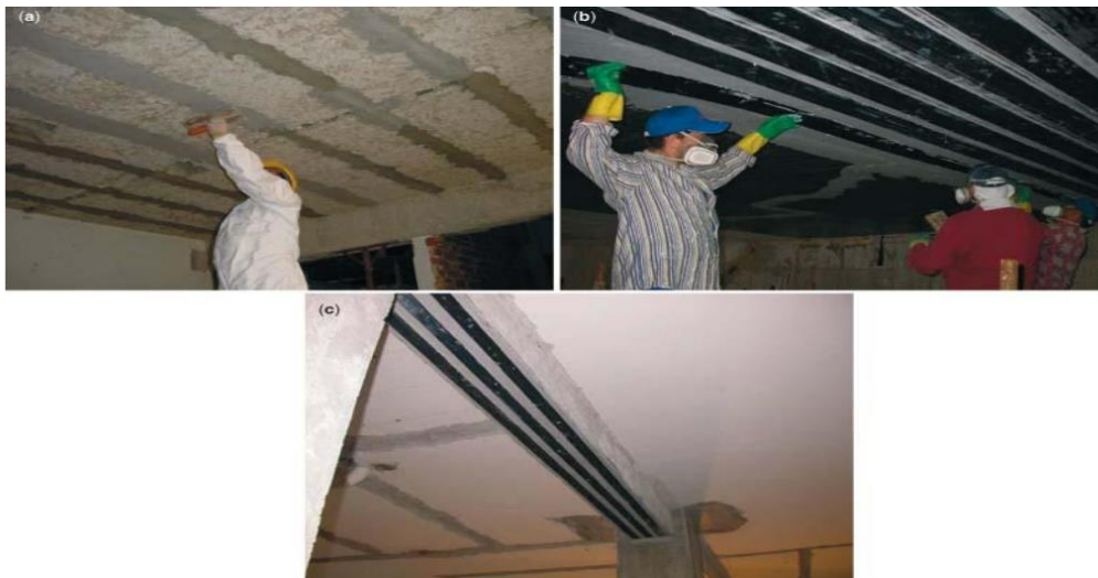
Εικόνα 3-23: Εργασίες τοποθέτησης φύλλων FRP σε πλάκα και δοκό για καμπτική ενίσχυση (προετοιμασία επάλειψη επιφάνειας με εποξική ρητίνη και τοποθέτηση στρώσεων πολυμερούς)
