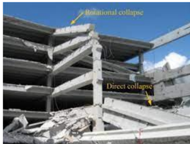
Εικόνα 2-32: Πλήρης κατάρρευση του υποστυλώματος στους άνω ορόφους που θα ταξινομούταν ως βλάβη βαθμού E
