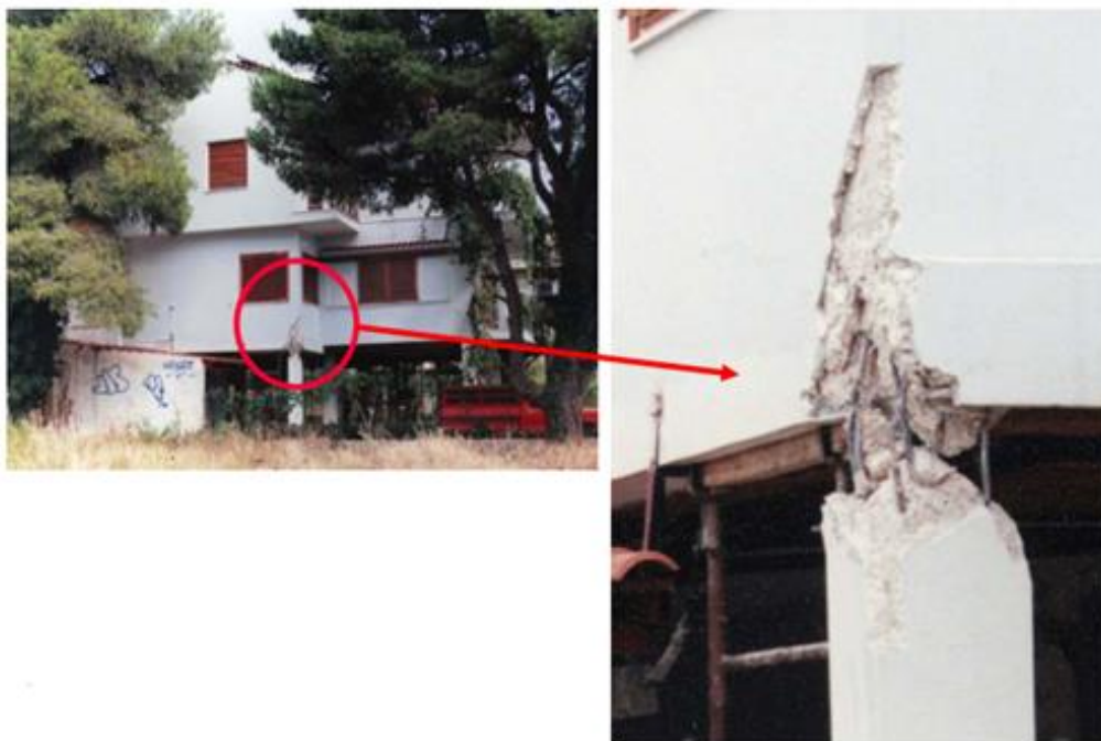
Εικόνα 2-38: Αστοχία ακραίου κόμβου με ψαθυρή αστοχία και του άκρου του υποστυλώματος λόγω έλλειψης συνδετήρων και ανεπαρκούς αγκύρωσης. Αθήνα σεισμός 1999. [19]
