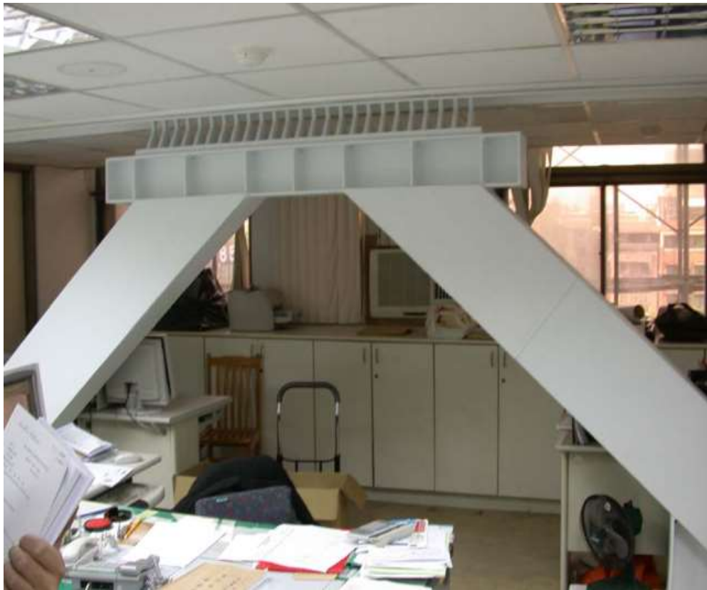
Εικόνα 5.23 Σύστημα TADAS εγκατεστημένο σε κτίριο στο TAIPEI LIVING MALL
