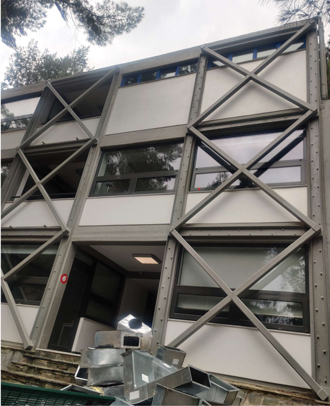
Εικόνα 7.2 εξωσκελετός σε υφιστάμενο κτίριο. Διακρίνεται η επιλογή που έχει γίνει σε συγκεκριμένα ανοίγματα τα οποία δεν διαταράσσουν την λειτουργία του κτιρίου.
