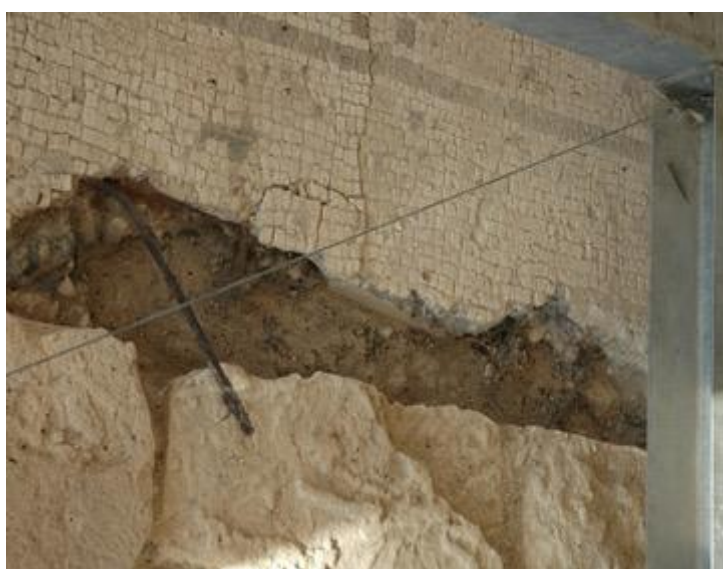
Εικόνα 3-29: Ανασηκώσεις και ρηγματώσεις λόγω οξειδωμένων μεταλλικών στοιχείων στο Γεωμετρικό ψηφιδωτό δυτικά των Μονομάχων στην Οικία Μονομάχων στο Κούριο, (2006), Συνεργείο Συντήρησης Ψηφιδωτών.
