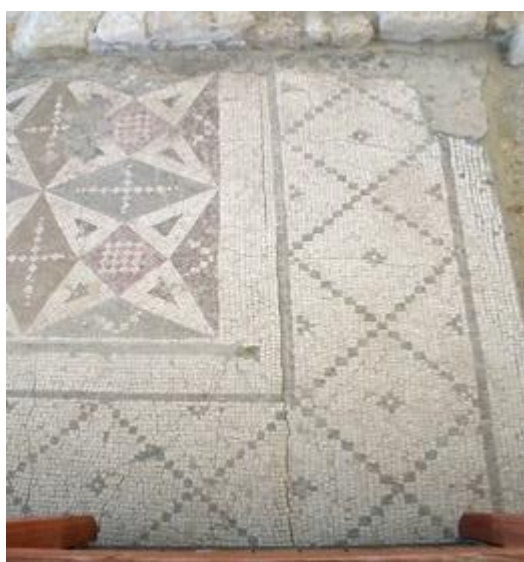
Εικόνα 3-30: Ρηγματώσεις στην επιφάνεια του Γεωμετρικού ψηφιδωτού λόγω απόσπασης και επανατοποθέτησης σε οπλισμένο τσιμεντοκονίαμα. Ψηφιδωτό δυτικά των Μονομάχων στην Οικία Μονομάχων στο Κούριο, (2006), Συνεργείο Συντήρησης Ψηφιδωτών.
