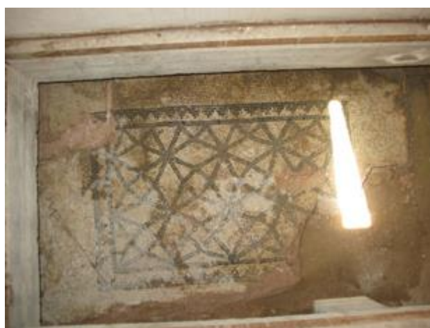
Εικόνα 3-6: Ψηφιδωτό στο δωμάτιο 5 στην Οικία Διονύσου στην Κάτω Πάφο με λιμνάζοντα ύδατα λόγω δυσλειτουργίας των αγωγών απομάκρυνσης υδάτων, (2010), Συνεργείο Συντήρησης Ψηφιδωτών.
