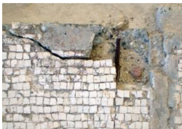
Εικόνα 3-28: Αποκόλληση και ρηγματώση του Γεωμετρικού ψηφιδωτού της Κεντρικής Αυλής στην Οικία Μονομάχων στο Κούριο λόγω οξείδωσης των μεταλλικών στοιχείων που χρησιμοποιήθηκαν στα υποστρώματα, (2006), Συνεργείο Συντήρησης Ψηφιδωτών.
