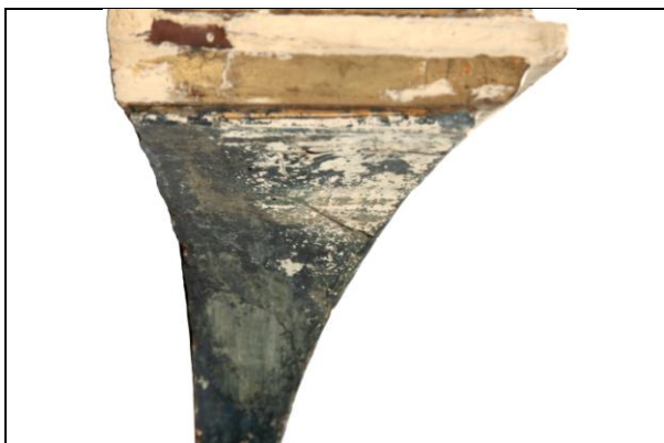
Εικόνα 3. 36: Λεπτομέρεια της κορνίζας. Διακρίνονται απώλειες της ζωγραφικής μίμησης μαρμάρου και ρωγμή.
