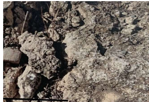
Κατάσταση διατήρησης της στρωματογραφίας του επιχρίσματος
