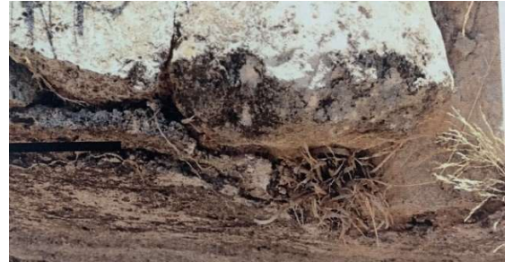
Λεπτομέρεια αποκόλλησης επιχρίσματος.
