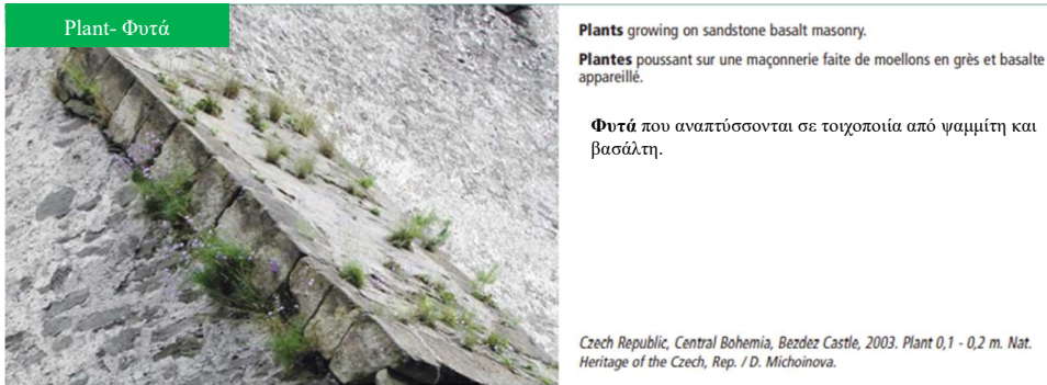
Εικόνα 5.25. Φυτά που αναπτύσσονται σε τοιχοποιία.
