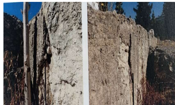
Λεπτομέρεια περιοχής Α, κατάσταση διατήρησης της στρωματογραφίας. (αριστερά). Λεπτομέρεια περιοχής Β, αποκόλληση επιχρίσματος. (δεξιά).
