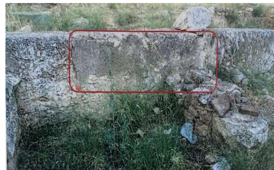
Κατάσταση Διατήρησης Επιχρισμάτων
