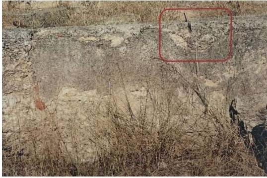
Κατάσταση διατήρησης του επιχρίσματος.
