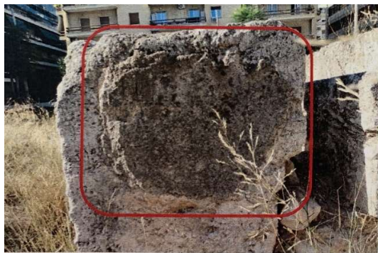
Κατάσταση Διατήρησης Επιχρισμάτων
