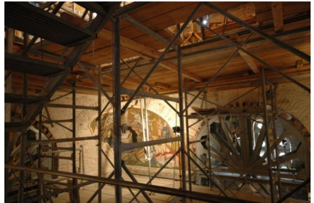
Εικόνα 1.16 Εσωτερικό της Μονής κατά τη διάρκεια επισκευών και συντήρησης μετά το σεισμό του 1999
