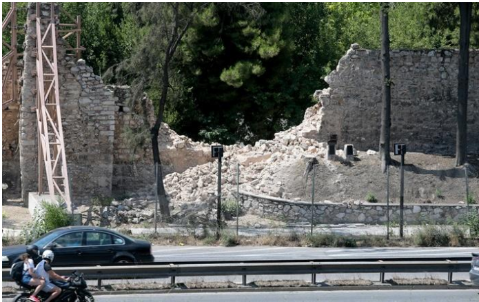
Εικόνα 1.17 Κατάρρευση τμήματος του περιβόλου μετά το σεισμό του 2019
