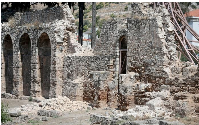
Εικόνα 1.19 Εσωτερική πλευρά του περιβόλου της Μονής μετά το σεισμό του 2019
